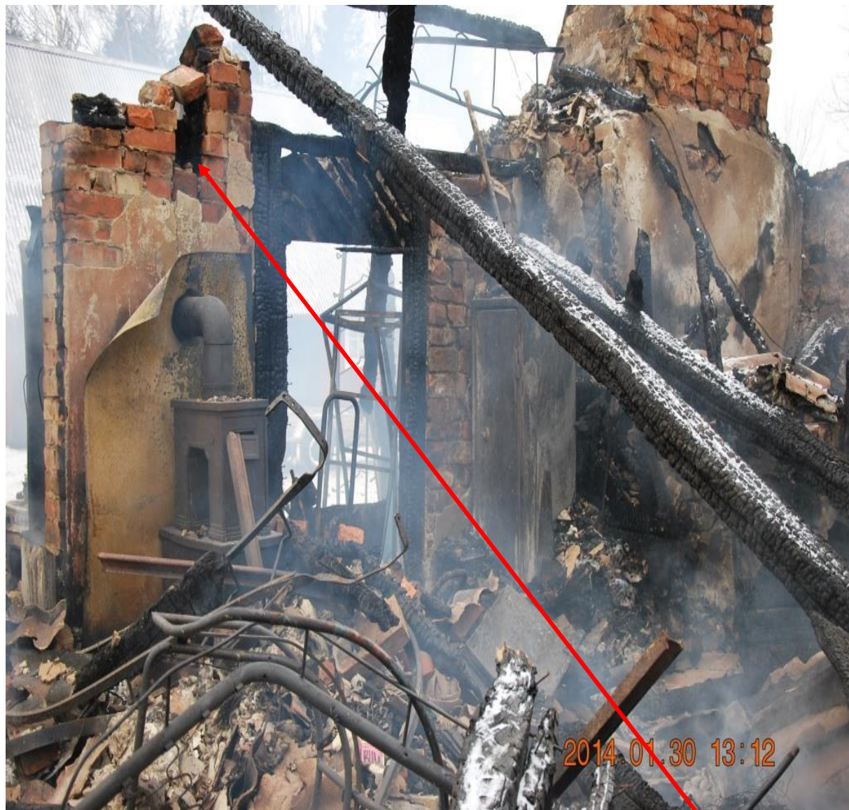
Närbild på kvarvarande del av skorstenen där branden startat.
