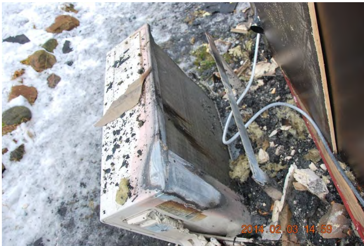
Ytterdelen av värmepumpen även dessa skador är sekundära värmeskador.
