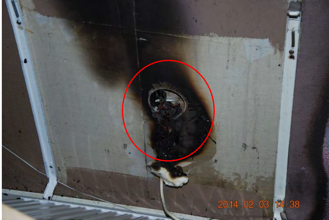
El element bortlyft, visar på att branden kommer inifrån väggen.
