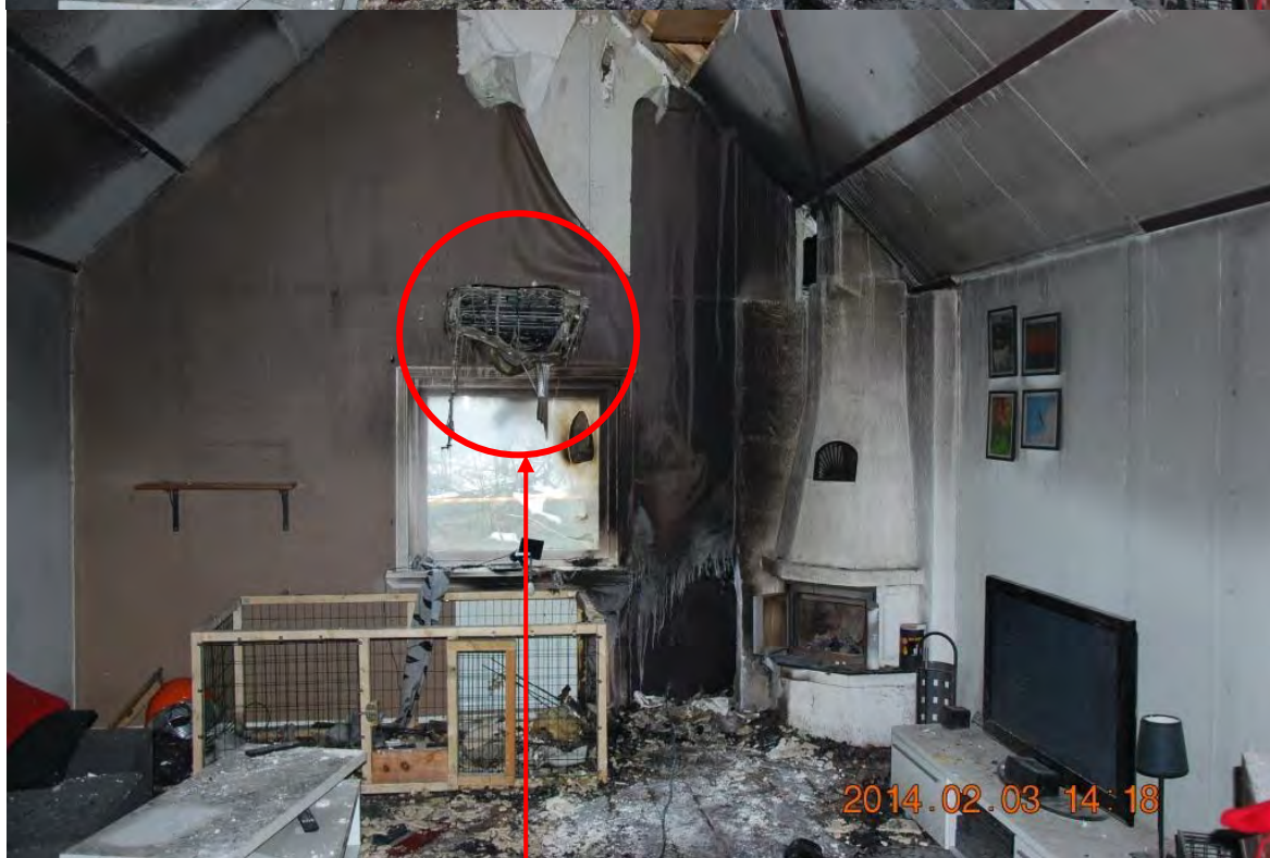
Värmepumpens innerdel, sekundära värmeskador.
