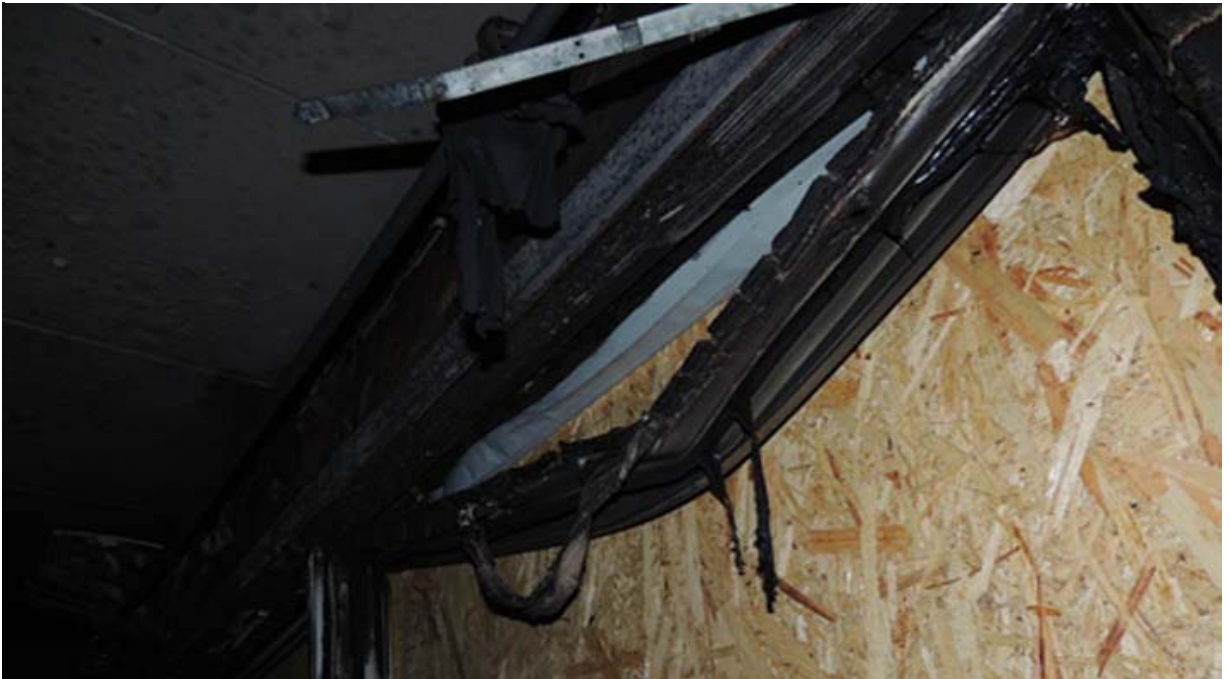
Bild 2 Uttryckt karm vid balkong
