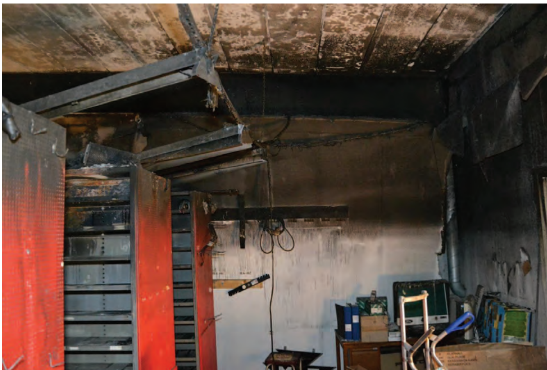
Bild: Deformerad vägg, vy från lagerlokal.
