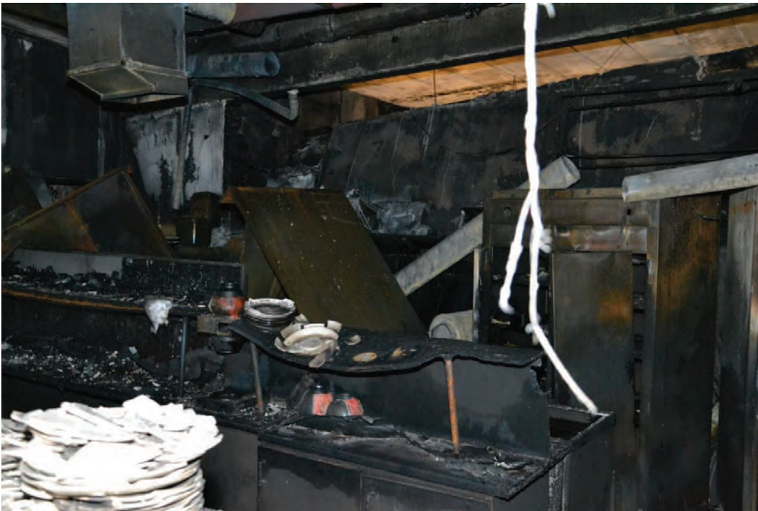
Bild: Deformerad vägg från kök mot lager.
