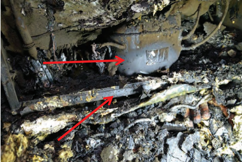
Bild från frysens kompressorenhet. Här syns lågt belägna brandskador.
