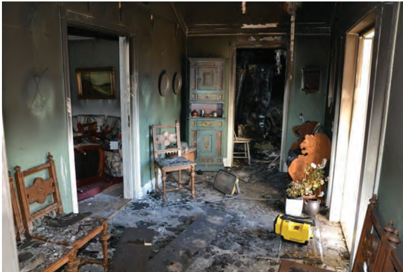
Bild från hall med kök i bakgrund. Sot- och måttliga brandskador syns i bilden.
