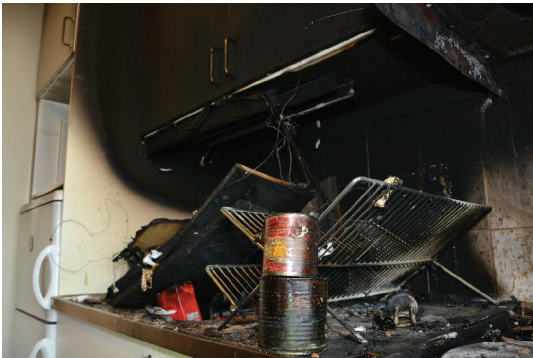
Bild visar sekundära brandskador i underskåp. Ej orsakat av elfel.
