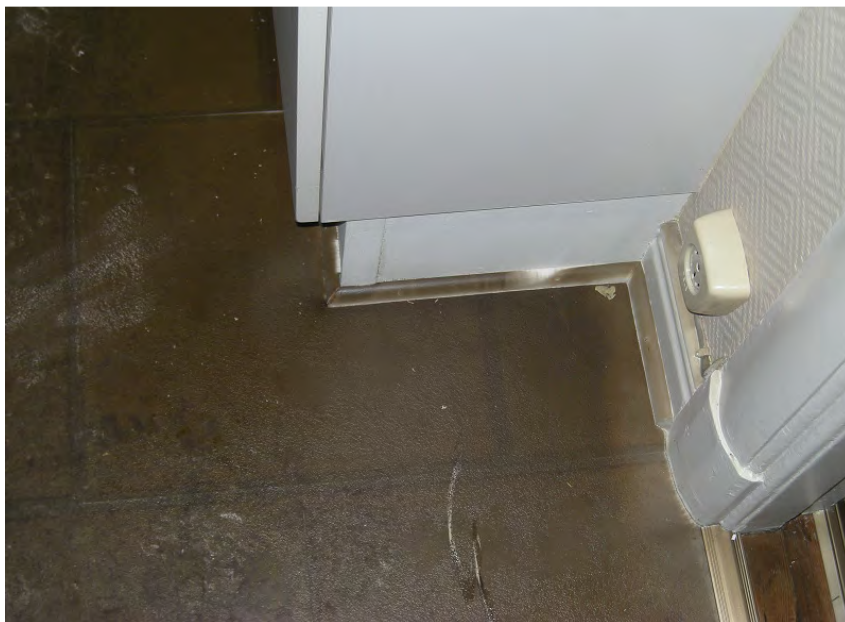
Figur 8, Sotbeläggning i en lägenhet på entréplan, det våningsplan som ligger närmast källaren
