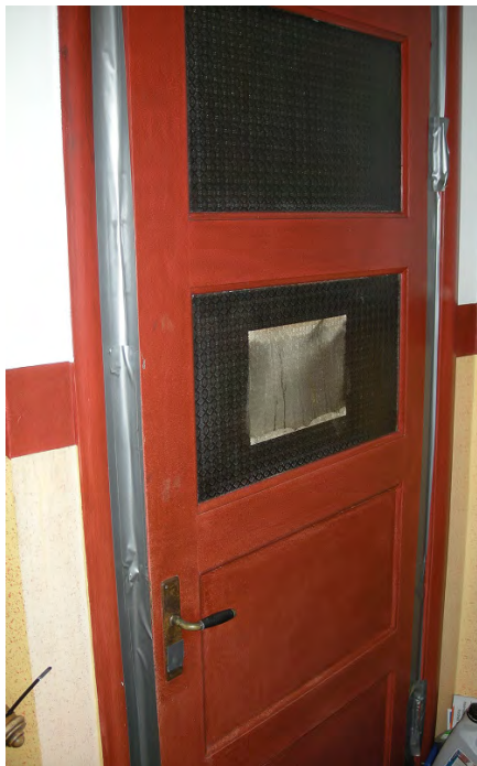
Figur 10, Dörr mellan källare och trapphus B. Dörren stod öppen vid brandkårens framkomst. Uppfyller inte nybyggnadskraven gällande brandavskiljning.
