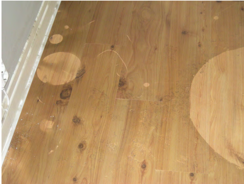
Figur 9, Tydlig sotbeläggning i lägenhet på övre våningsplan.
