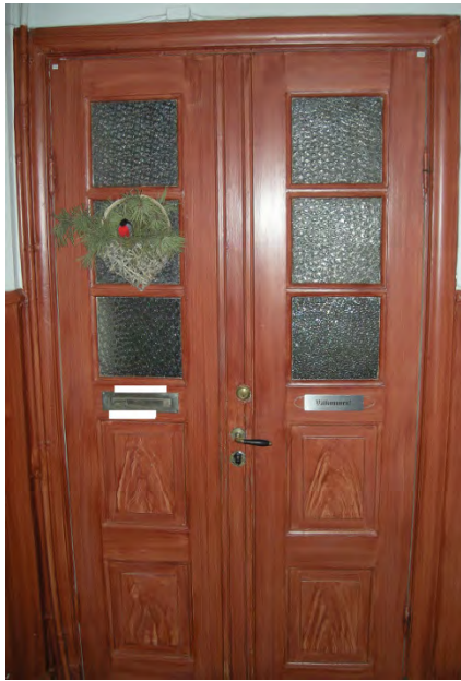
Figur 7, Lägenhetsdörr med begränsat brandmotstånd. Uppfyller inte dagens nybyggnadskrav gällande brandteknisk avskiljning.
