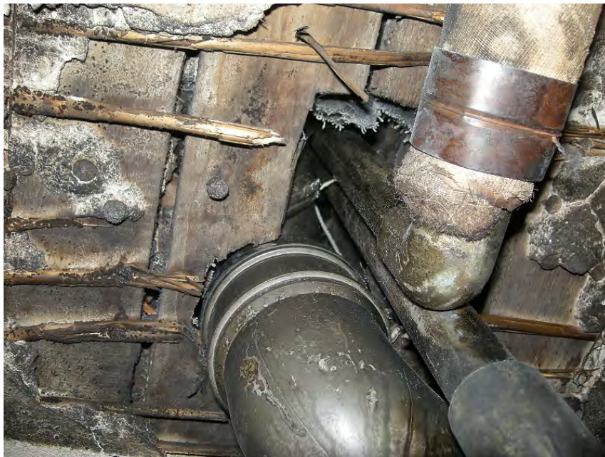
Figur 5, Otätheter i rördragning i bjälklagen
