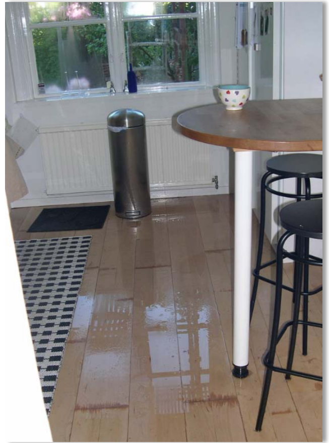
Bild 7. Vattenskador i fastigheten.
