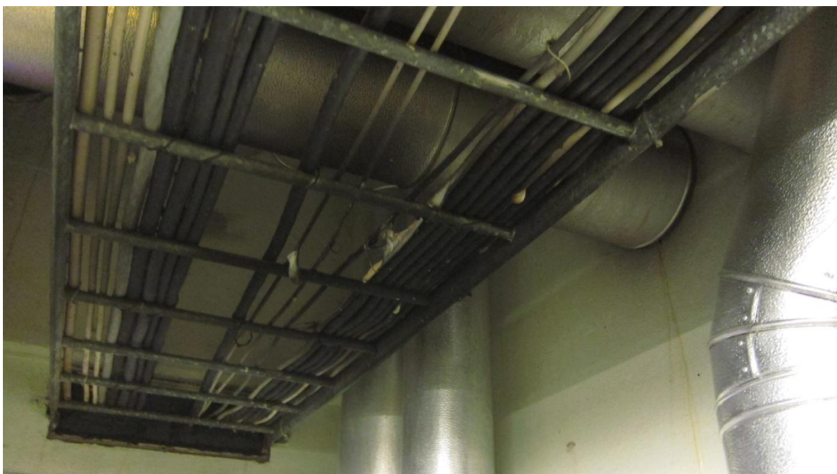
Kabelstegen samt rör ovanför branden.
