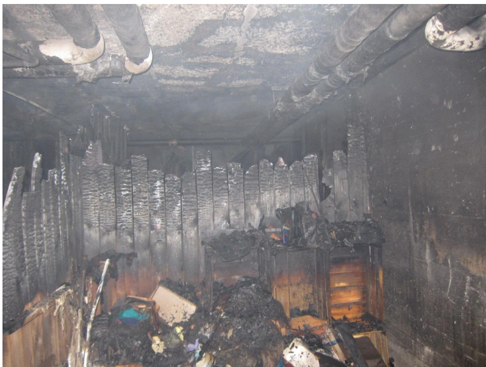
Branden har spridits i taknivå. Ovanför rören syns Nikeplattorna.
