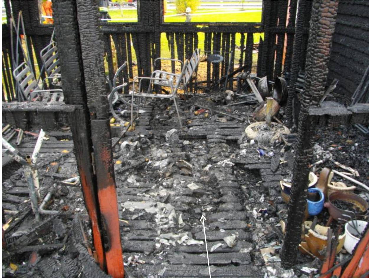
Kraftiga brandskador som inte verkar orsakats av inredning på altanen
