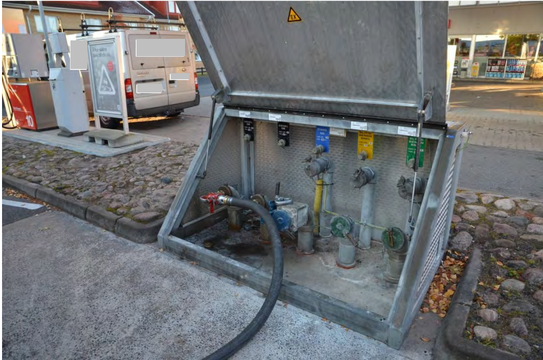
Påfyllnadsplatsen. Fyllning av dieselcistern pågår
