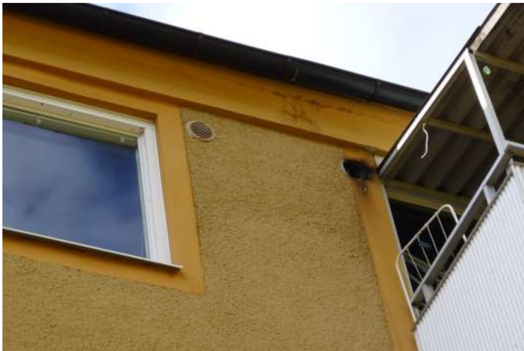
Tilluftsventilation. Drabbad lägenhet samt intilliggande med hel ventilator.
