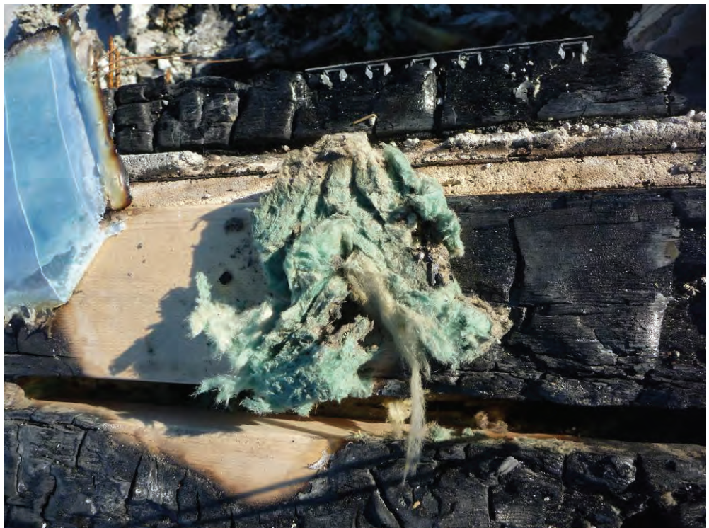
Bild 19 Brandisoleringen mellan modulerna samt de brandpåverkade reglarna.
