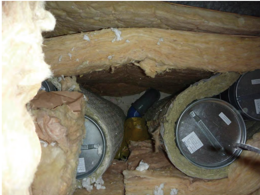
Bild 13 Ventilationssystemet och avloppsröret ovan schakttoppen sedan den nedstoppade mineralullsisoleringen med vindskyddspapp tagits bort. Röret och ventilationskanalen fortsätter sedan gemensamt rakt nedåt i bild.
