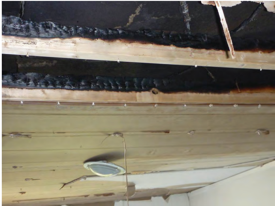
Bild 23 Exempel på brand i mellanrummet mellan lägenhetsmodulerna
