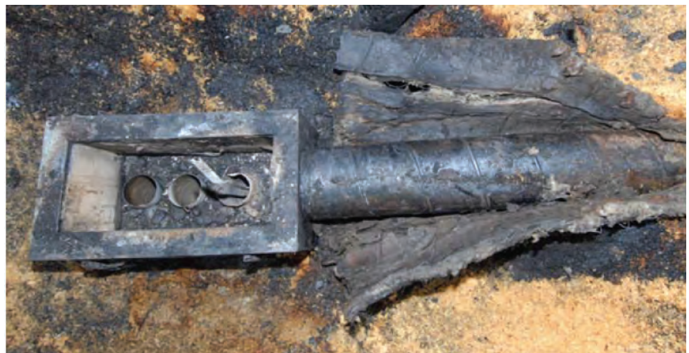
Bild 14 Bilden är tagen vid en brand med liknande förlopp i Umeå 2008. Lågorna och varma brandgaser har värmt upp kanalen så mycket att den blånat under den isolerade delen. Här skedde antändning av spånet via en glipa i brandisoleringen.
