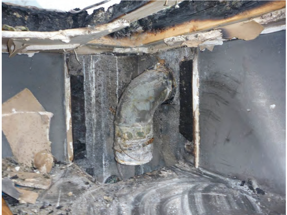
Bild 7 Brandskadorna ovan skåpet i köket. Skåpväggarna mot lägenheten har monterats bort. Notera hur oskadade bjälkarna ovan gipsen är.
