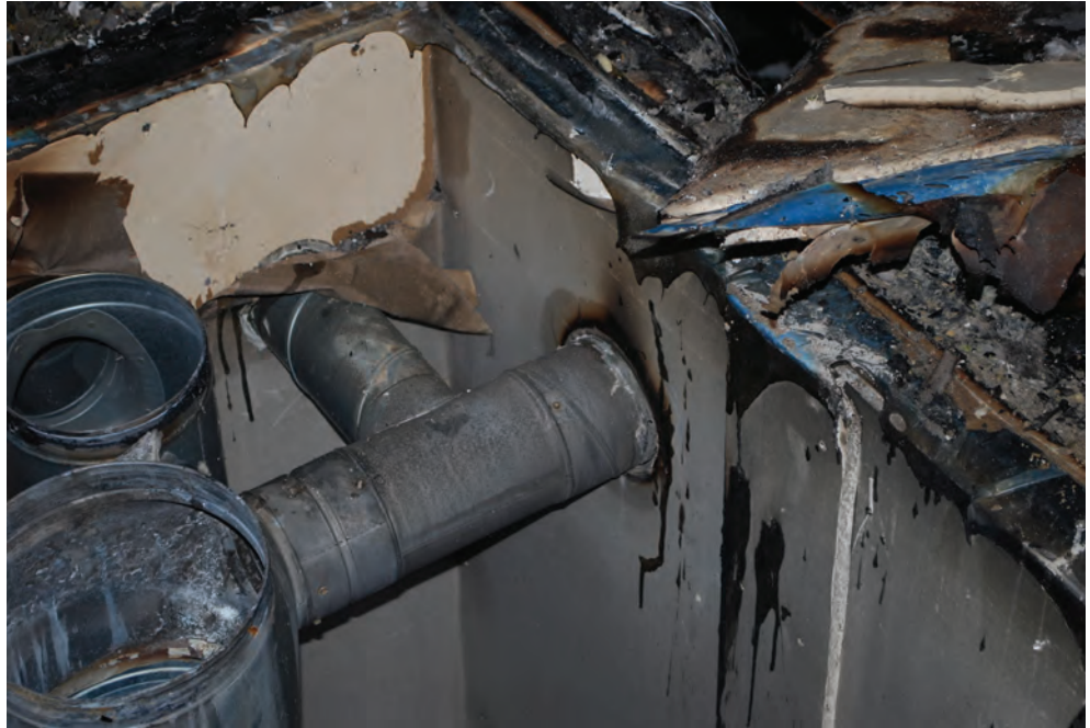
Bild 8 Schaktet och genomföringen till schaktet uppvisar endast ringa brandpåverkan
