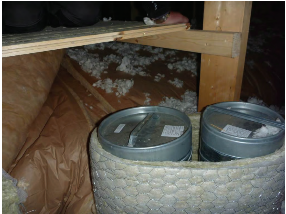
Bild 17 Visar närheten till brännbart material vid kanaltoppen. Avståndet till gångbryggan är ca 24 cm
