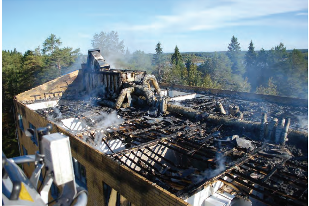
Bild 18 Bilden är tagen på morgonen den 31/8 när vindsbranden var släckt men det fortfarande brann i spalterna vid ytterväggen.
