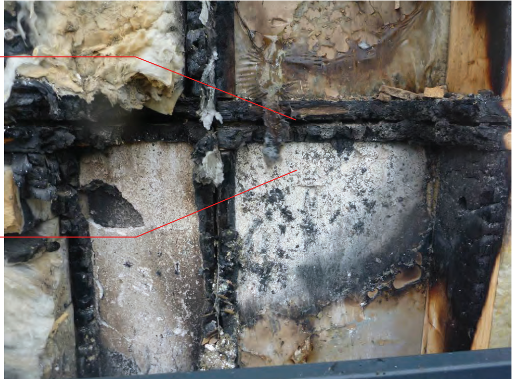
Bild 22 Bilden visar krysset där hörnen mellan 4 st lägenhetsmoduler möts. Gipsskivor mot lägenheterna och reglarna är kraftigt brandpåverkade. Lägenheten där branden startade ansluter uppe till vänster.
