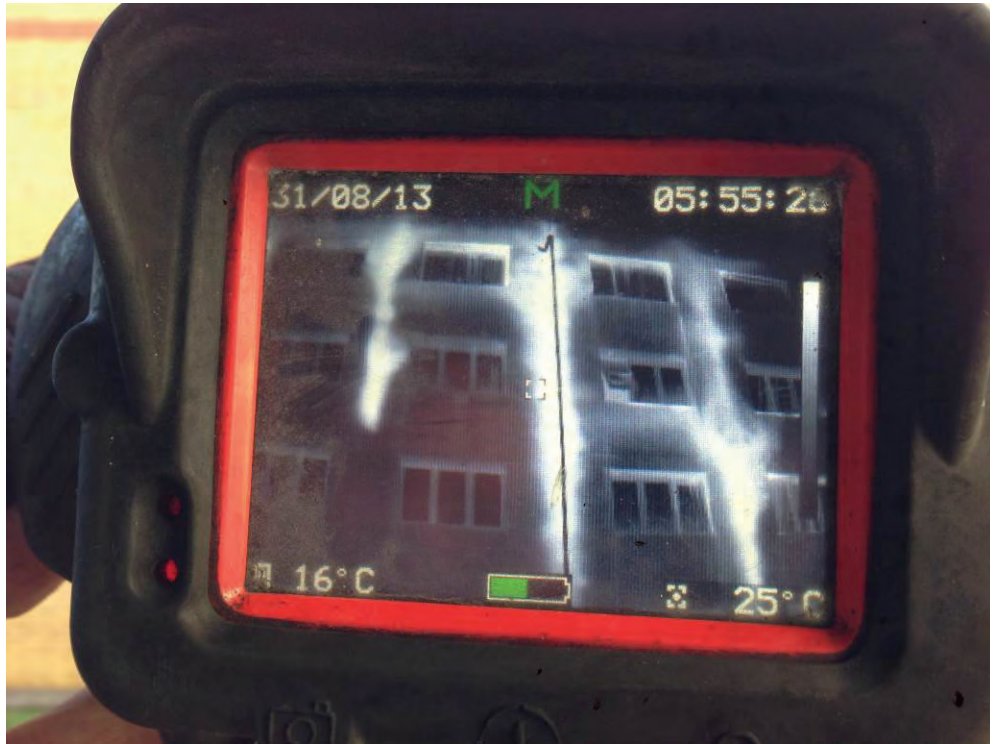
Bild 3 IR-kamerabild över brandspridningen i utrymmet mellan lägenhetsmodulerna.
