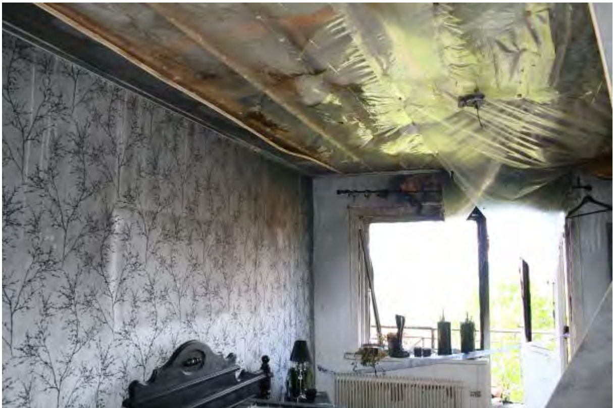
Bild 5. Brandlägenheten mot balkongen.
