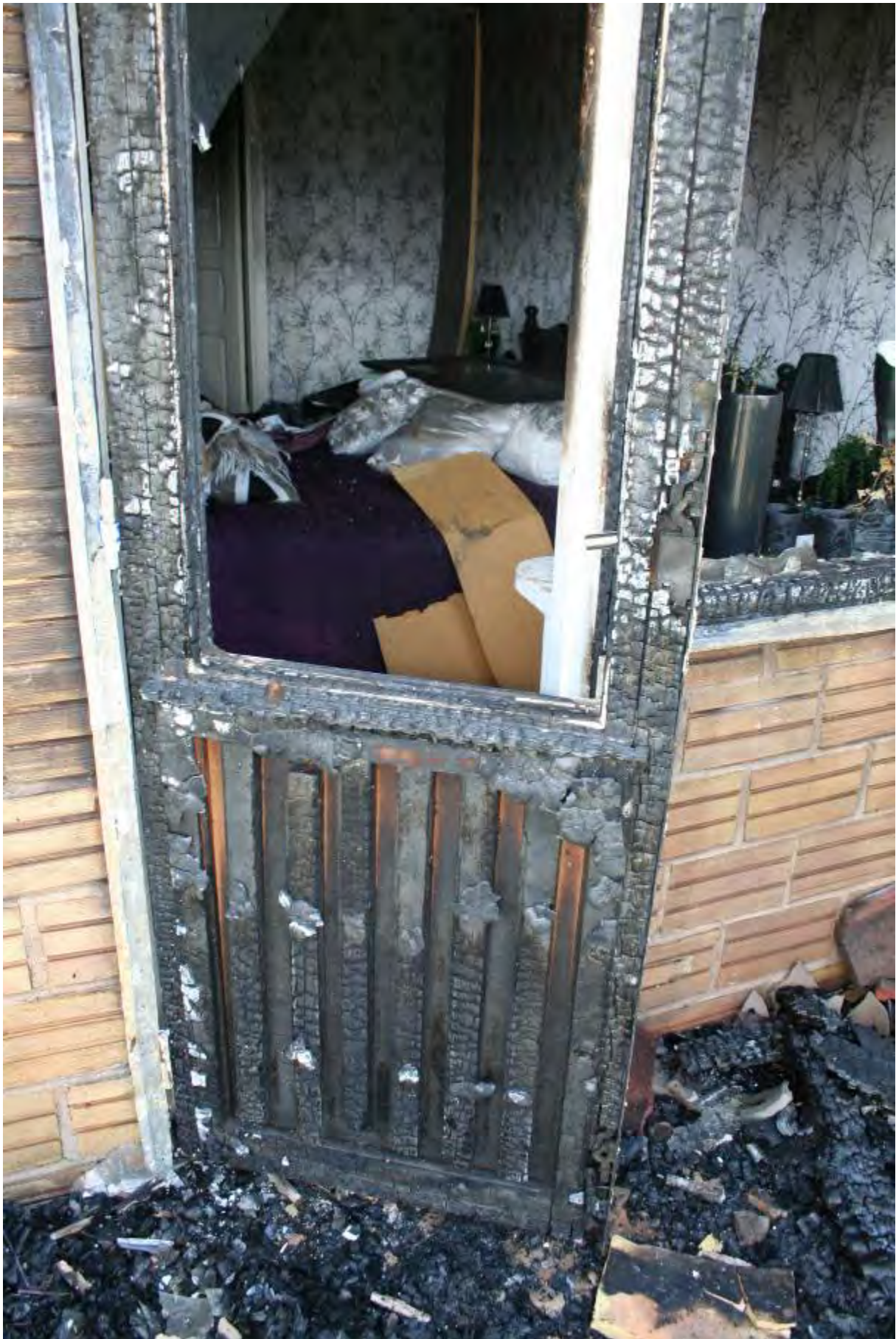
Bild 8. Låga brandskador på balkongdörren.
