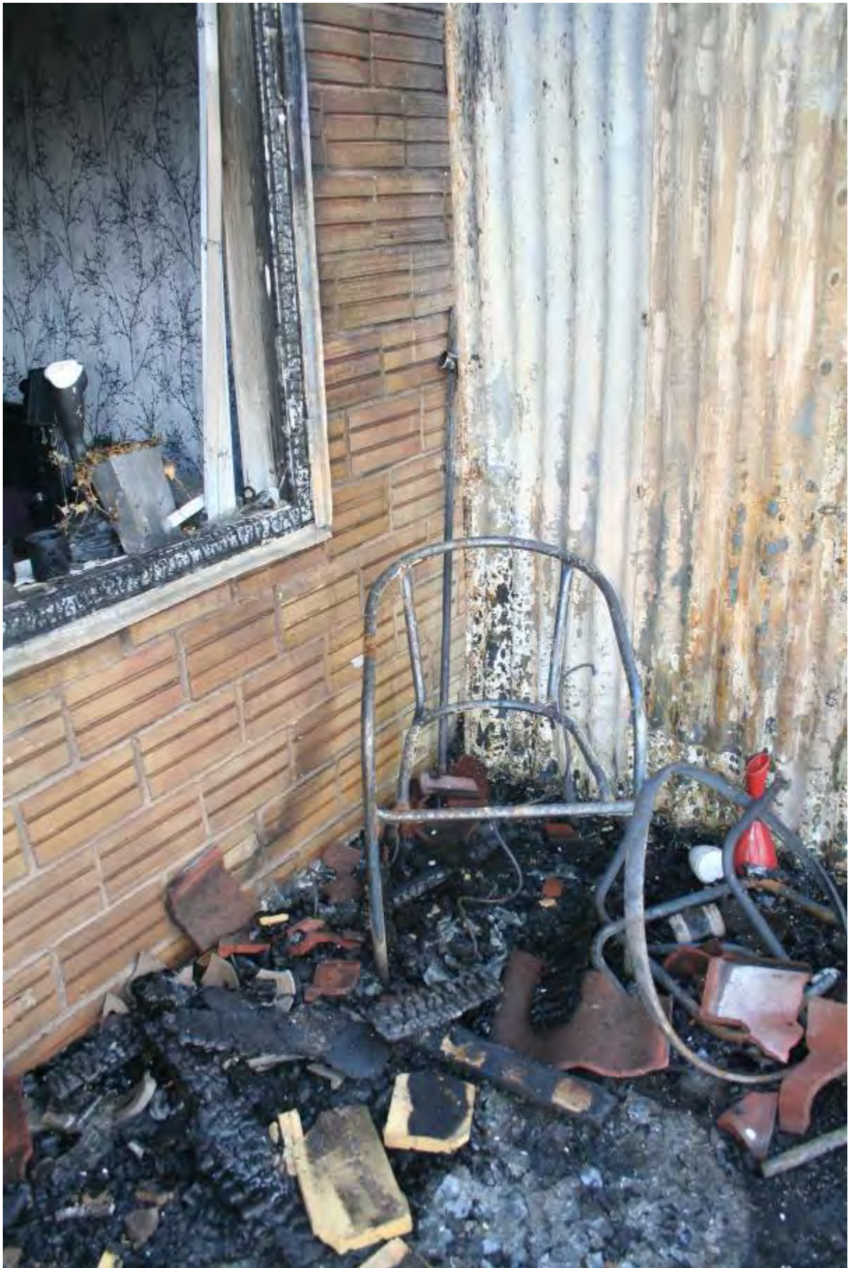
Bild 7. Balkongen med brännskador på fönsterbågen.
