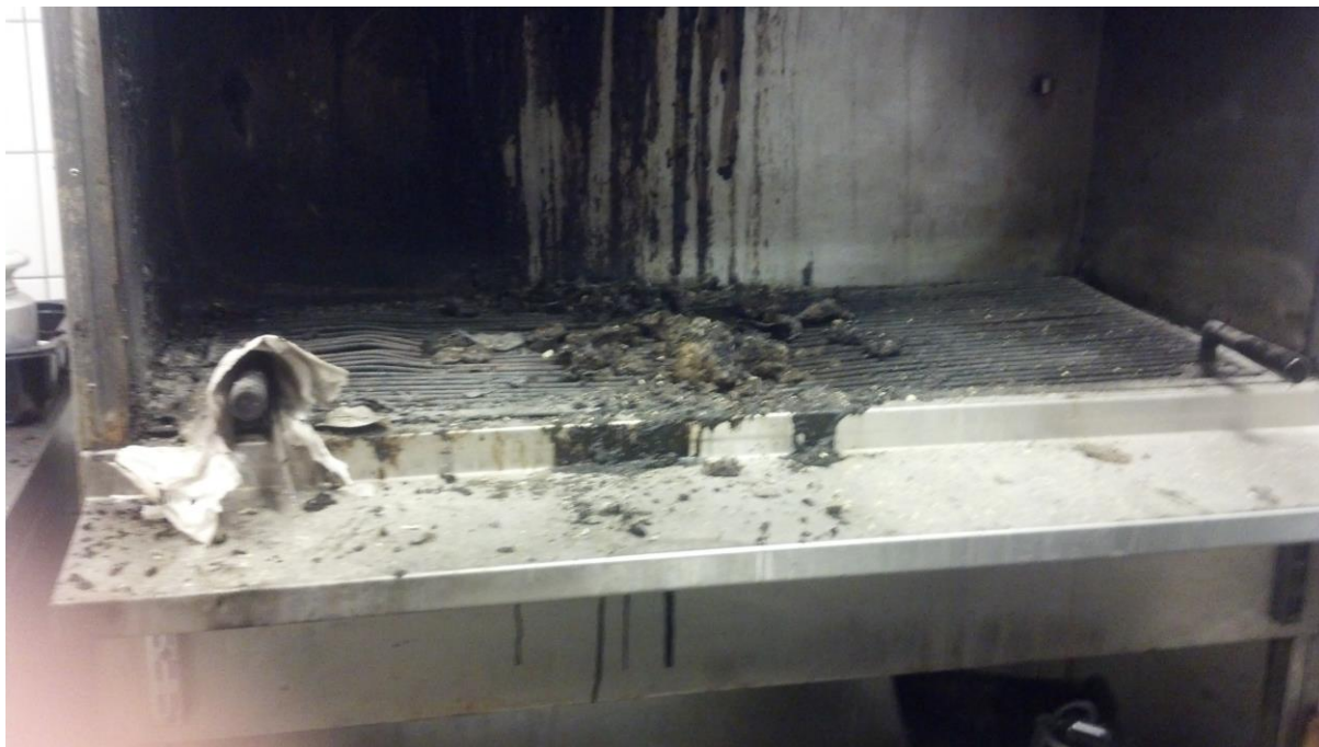
Bild 3. Brinnande fett har runnit ner från avgaskanal.
