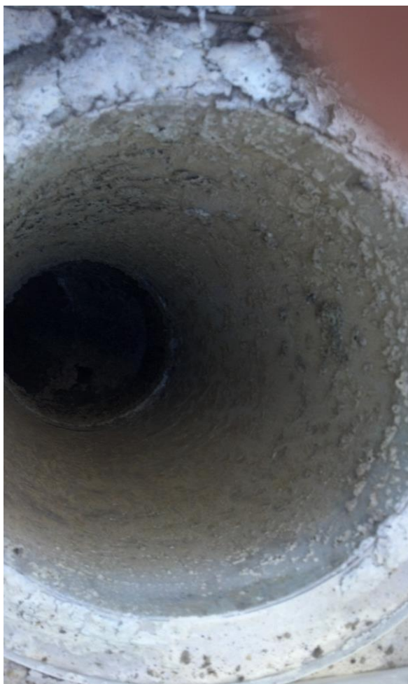
Bild 4. Avgaskanalen efter branden.
