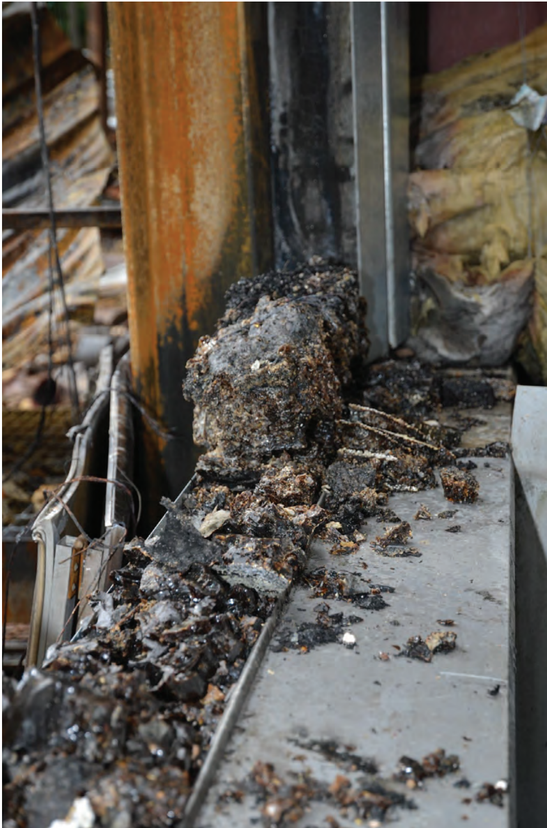
Plastsmälta på ovansidan av de stående betongblocken samt skyddsplåten
