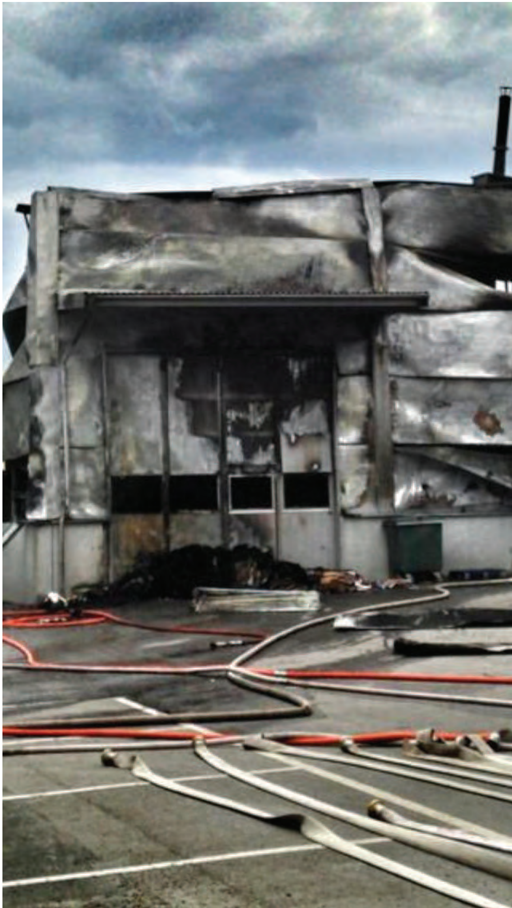
In/utlastningsporten med tydliga lågt placerade brandskador
