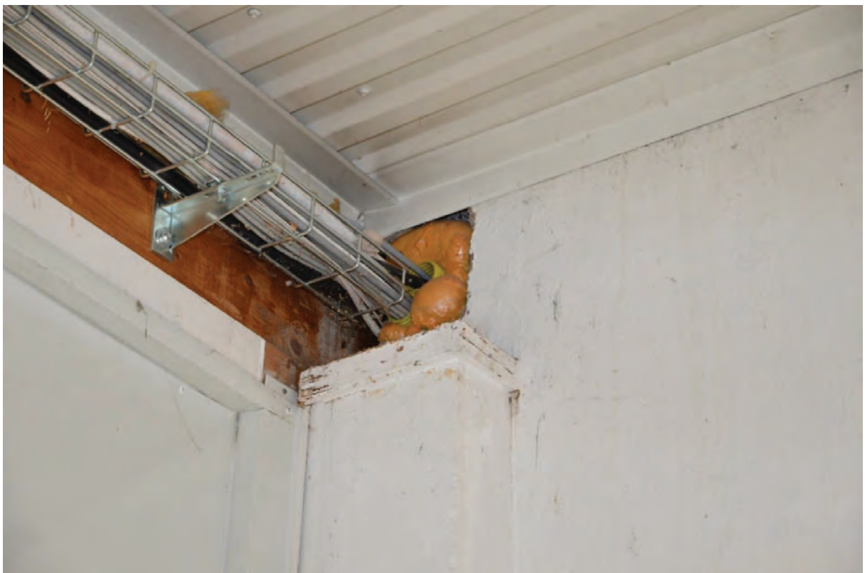
Genomföring som tätats på ett riktigt sätt och därigenom förhindrat brandspridning
