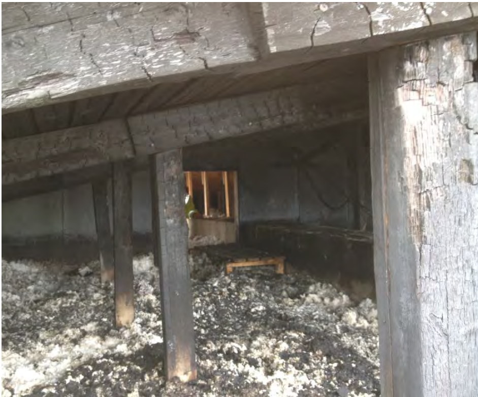
Bild på takkonstruktion med träreglar uppstöttade med träreglar direkt mot betongbjälklaget. Bilden är tagen från tvärsnittshålet och mot väster. På bilden ser man även den avskiljande vägg med lucka som upptäcktes i ett senare skede av insatsen
