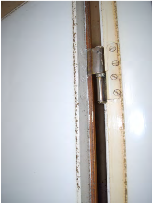
Figur 6. Lägenhetsdörr utan typgodkännande märkning av brandteknisk
