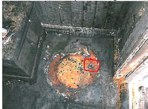
Bild 6 Brännmärke på golv från lampa markerad
