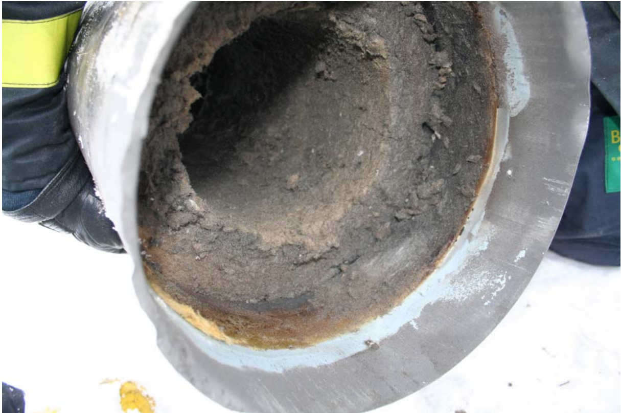
Bild 6. Isoleringen i skorstenen var värmepåverkad och porös.
