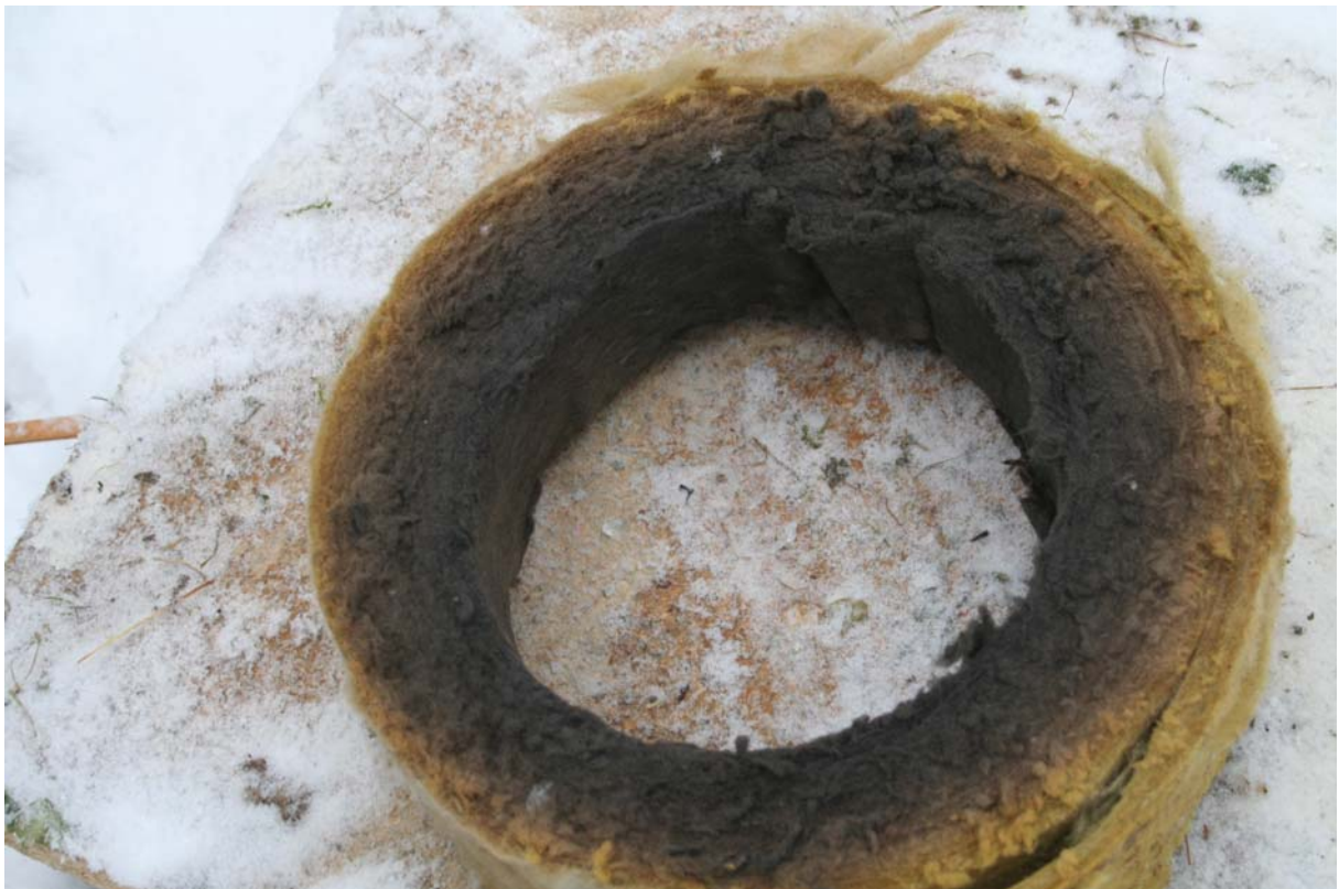
Bild 5. Påverkad isolerings ring som fanns i övergångsmodulen mellan rören.
