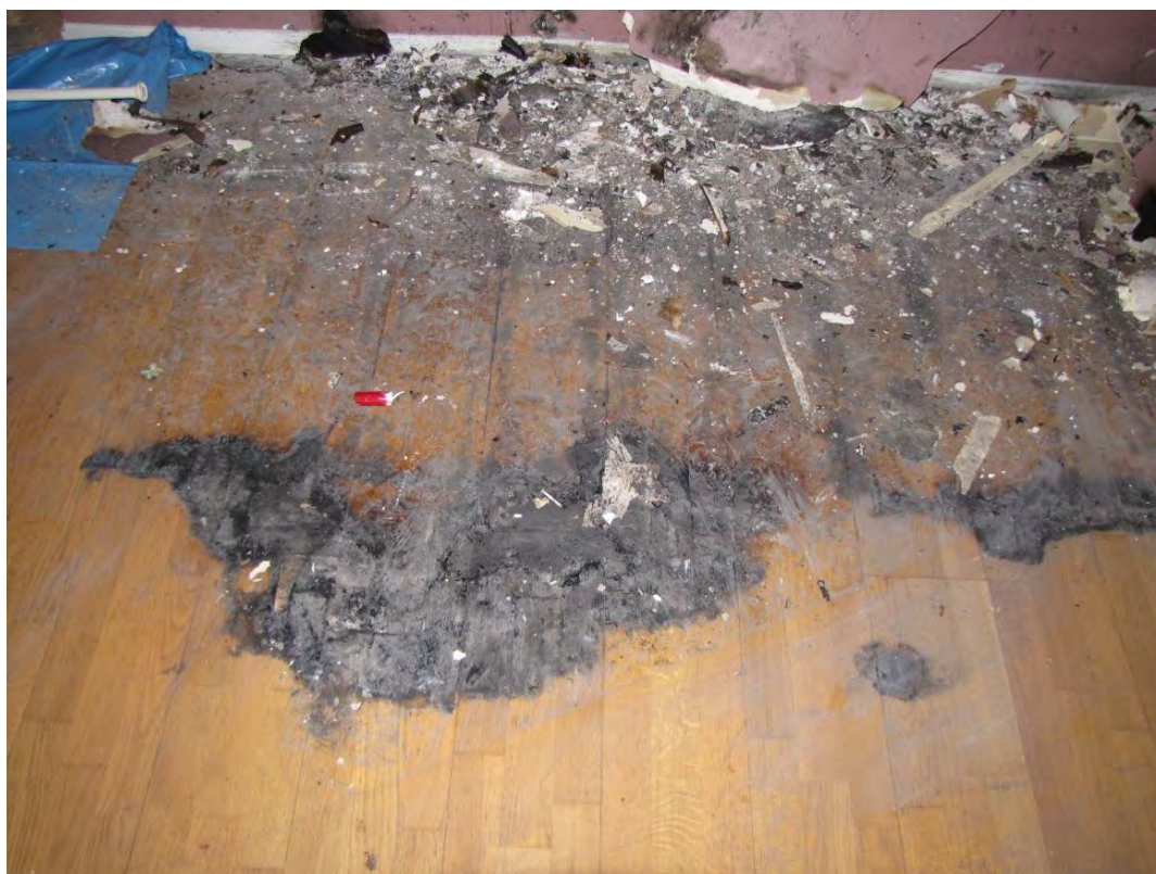
Bild 4. Märken efter den utspillda Bio-Etanolen när kaminen slets ner från väggen.
