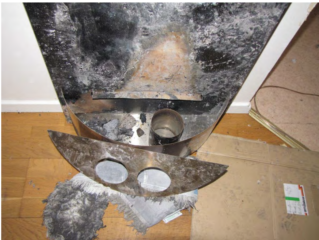
Bild 2. Här under halvmånelocket samlas vätskan vid spill och avger brandfarlig gas.
