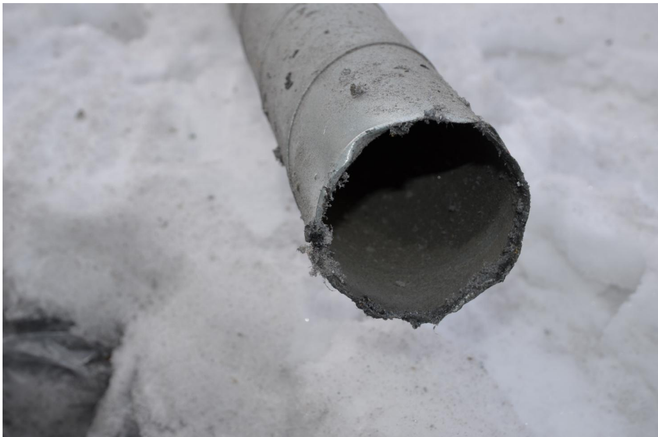
Plastdamm i kanal
