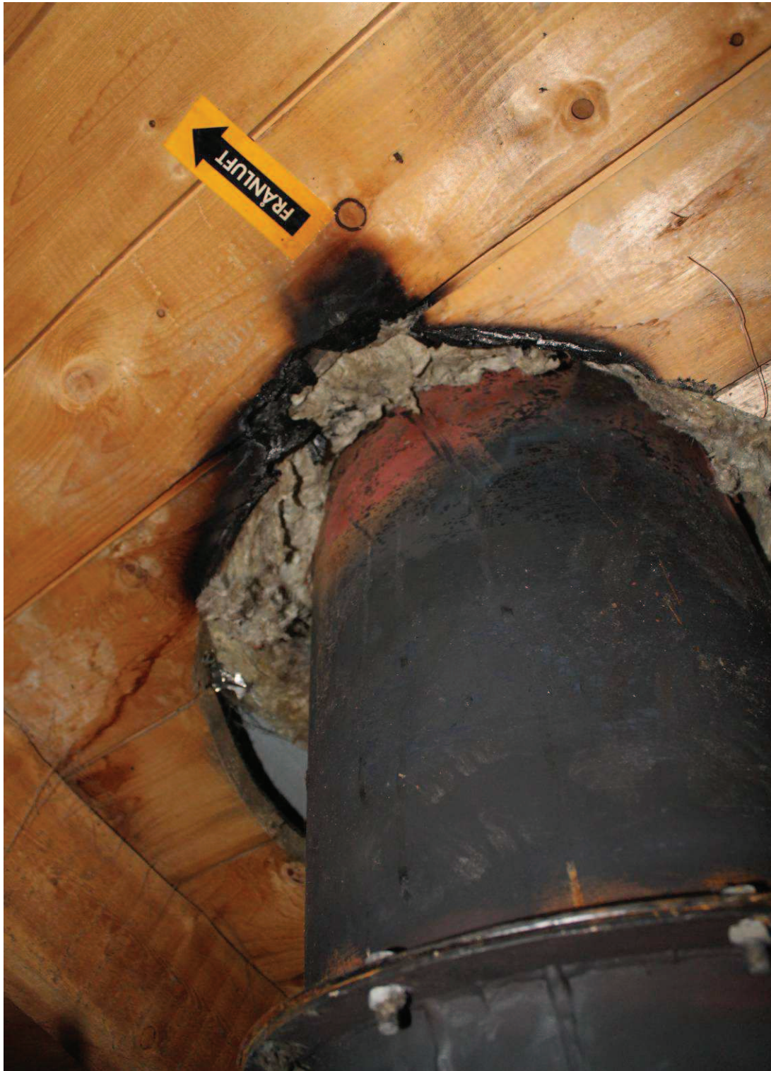
Figur 6 Det är tydligt att röret går lite för nära råsponten i yttertaket. Avståndet verkar vara större bortom röret och där har det klarat sig från antändning. Innan branden var det här röret rödmålat. Det har varit brand i röret ända till genomföringen genom yttertak.
