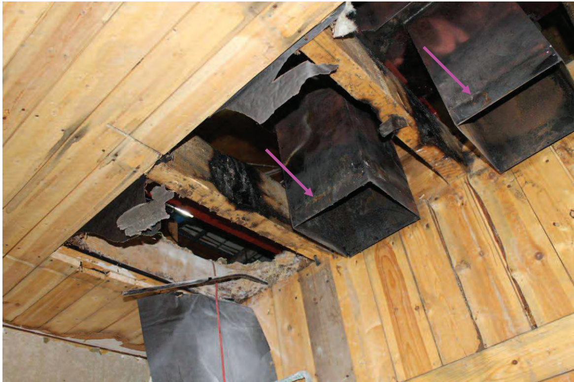
Figur 3 Vid pilarna syns det en rand, den visar hur mycket plåtrören gått omlott. Jag skulle vilja att de brännbara delarna var inklädda med gips och att rören gått omlott så att skarven legat ovan takstolarna. Då hade inte takstolen blivit utsatt för brand.
