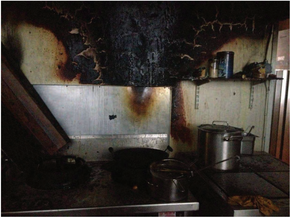
Figur 1 Den här bilden visar hur kraftig branden varit på spisen. Vid min brandplatsundersökning så var allting bortburet av saneringsföretaget. Jag har inte sett den "köksfläkt" som var installerad i köket. Jag tror att branden pågått flera minuter.
