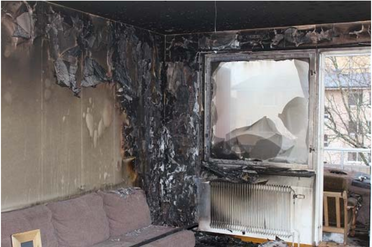
Gaveldelen på soffan lämpades ut på balkongen av räddningstjänsten.
