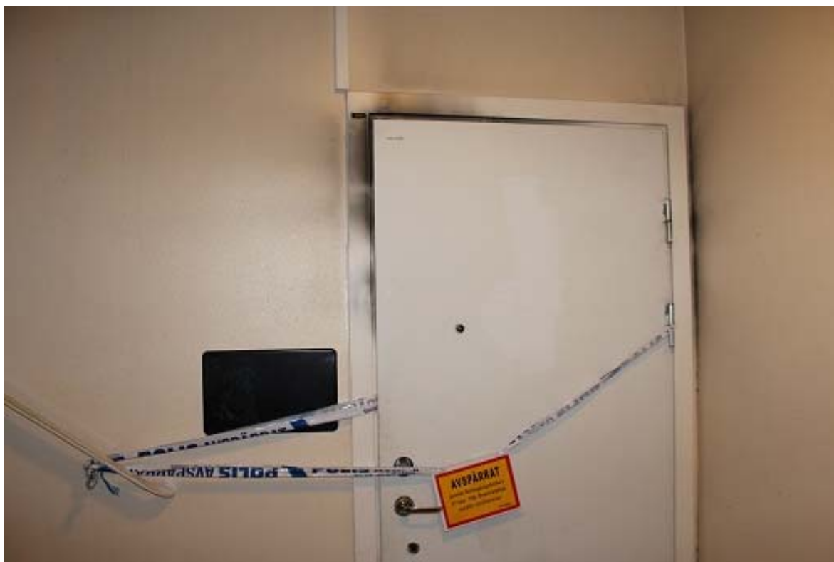
Brandlägenheten utifrån trapphuset.
