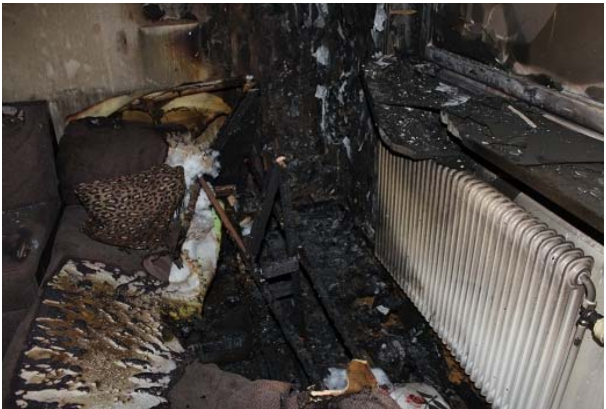
Soffan är placerad som den stod innan räddningstjänsten lämpade ut den på balkongen.
