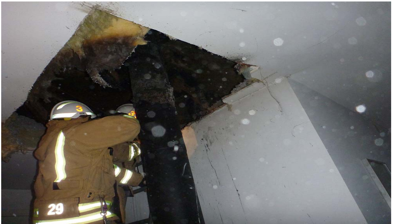
Bild från vardagsrummet, här ser man värmepåverkad isolering runt skorstenen
