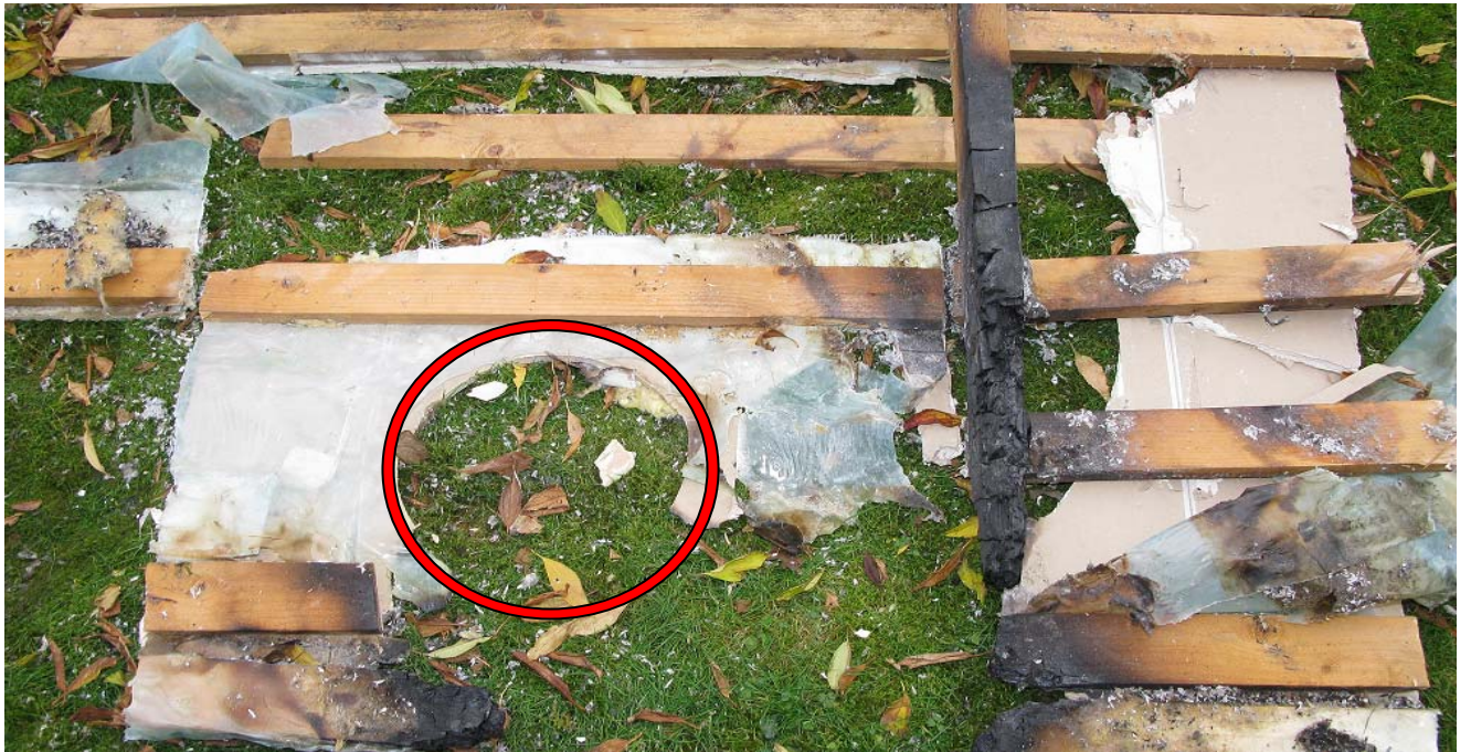
Delar av tak/vardagsrum – golv/vind, där ringen är placerad har genomföringen för skorstenen varit.
