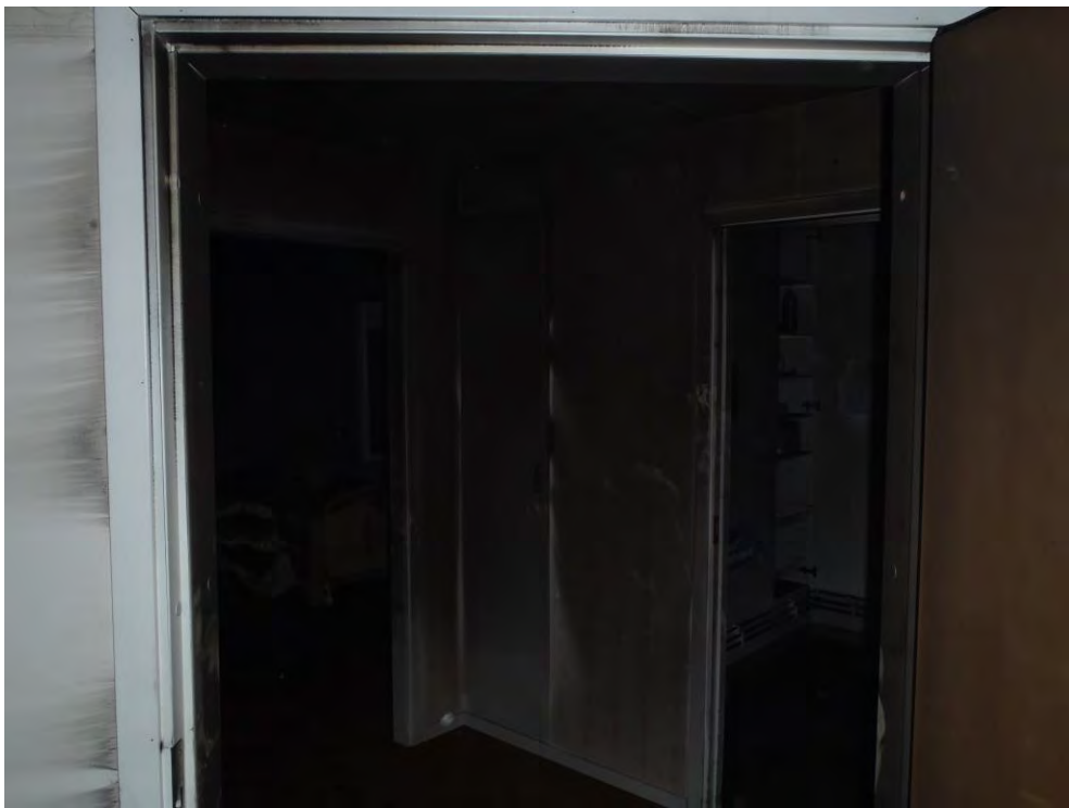
Bild 2. Sotbild innanför lägenhetsdörr. Badrum till höger. Brandrummet rakt fram. (Ger en bild av vad personalen påträffar vid första insats.)
