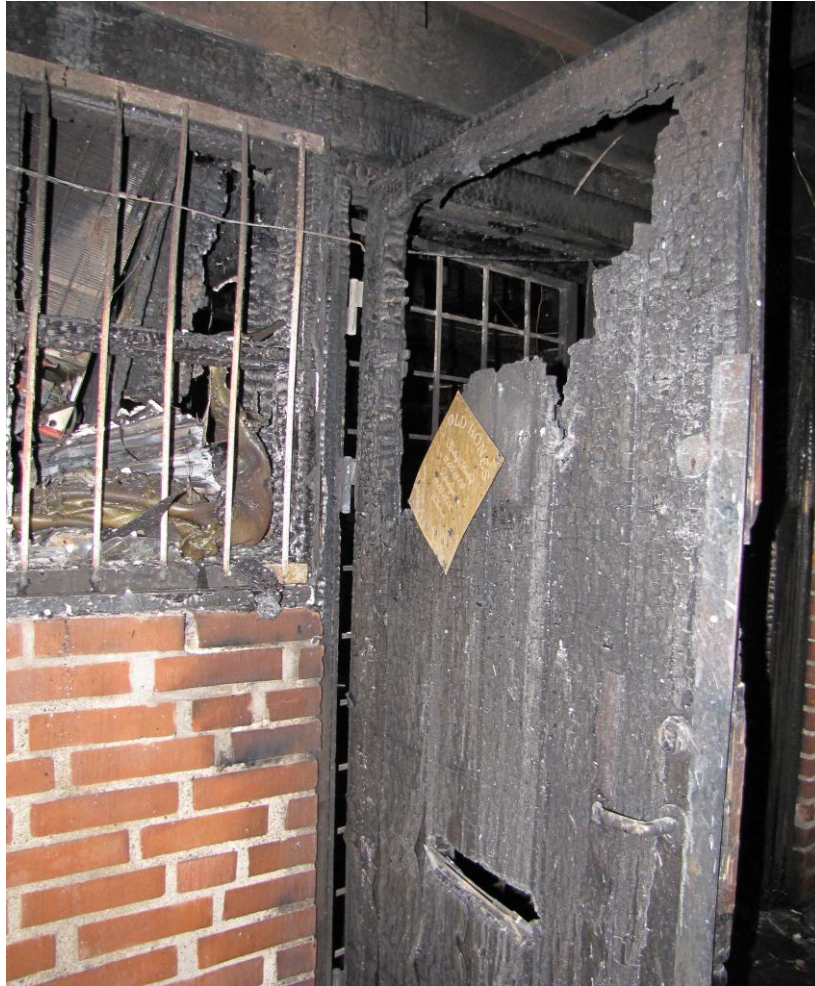
Bild 3. Brandspridning via fönster och dörr in till lokalen.
