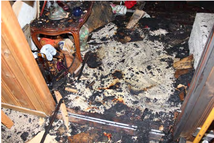
Brandskador på golvet till höger om eldstaden.
