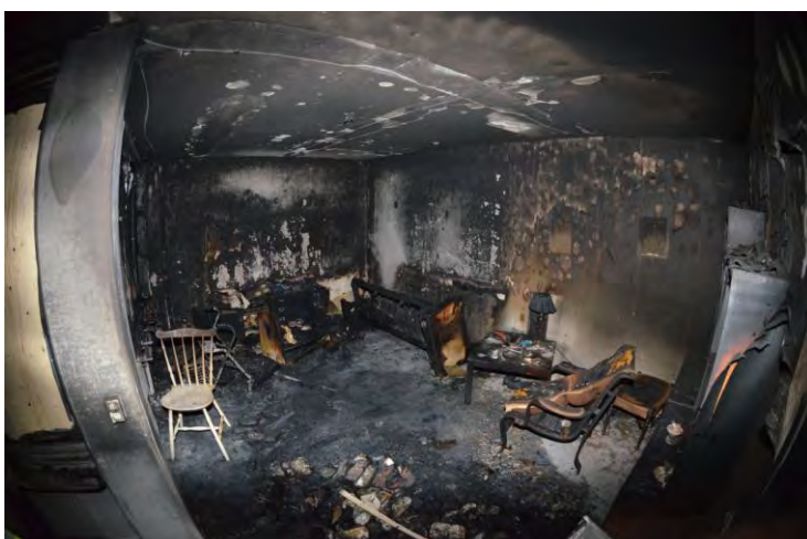
Vardagsrum med initialbrand i hörnet.
