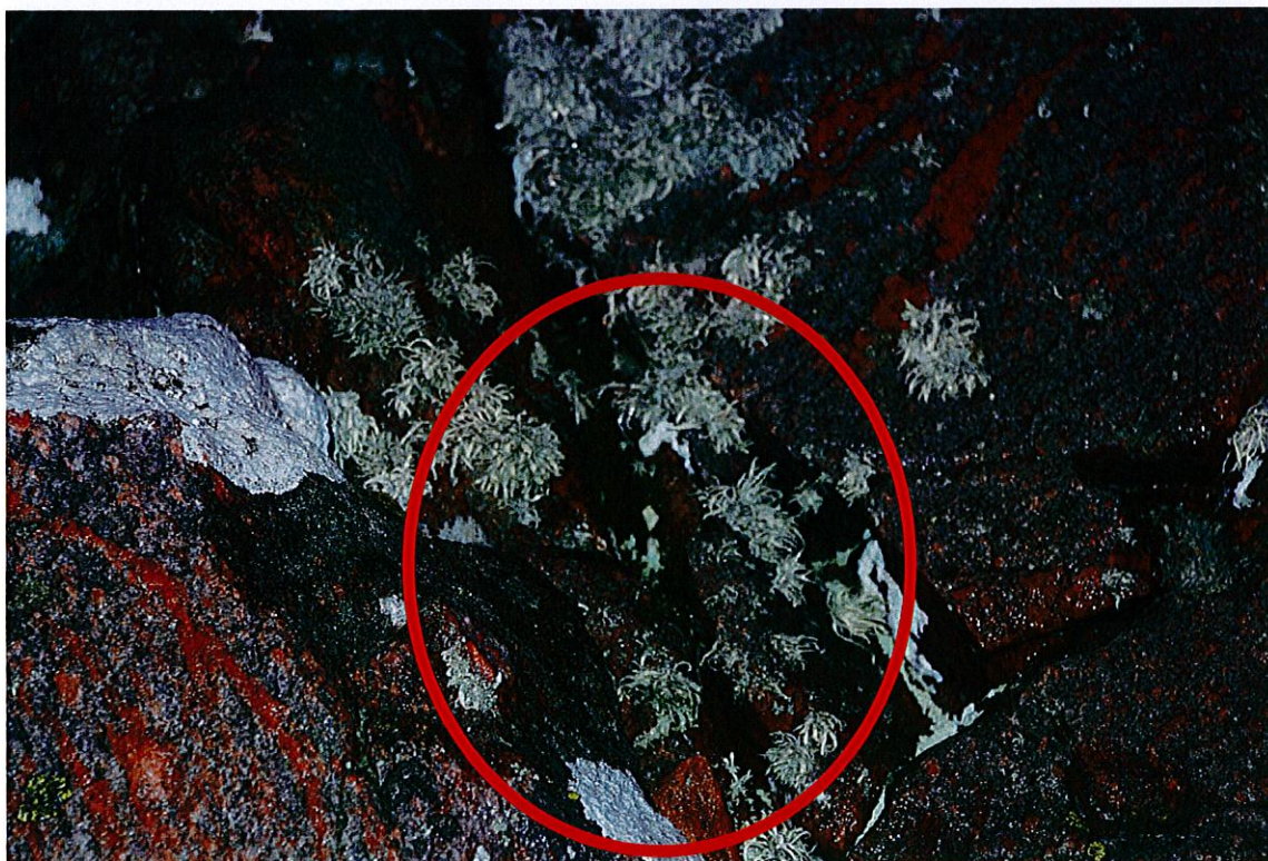
Spricka med risk för att brytas loss vid belastning.
