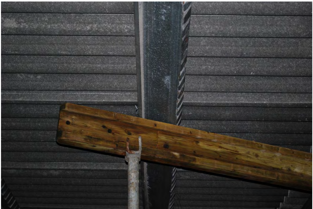
Bild 6 På denna bild syns det att träregeln stöttar upp en galvad stålprofil som vikt sig åt höger.
