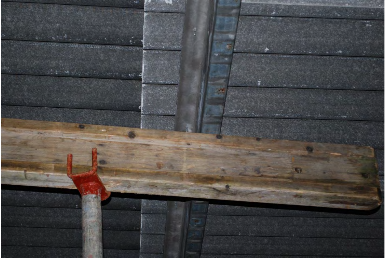
Bild 7 På denna bild syns det att träregeln stöttar upp en galvad stålprofil som inte vikt sig.
