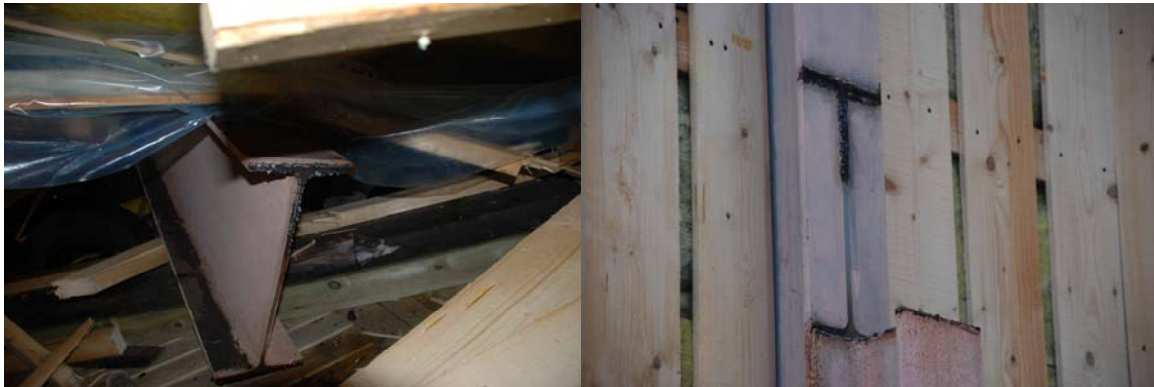
Foto 3 och 4. Balken som försköts från sin plats. Svetsfogar för balk.
