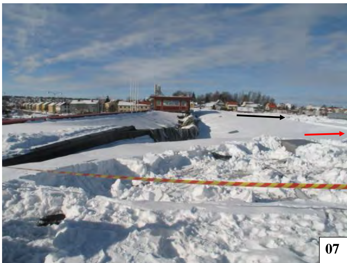
Rasets spricka har väderskyddas med presenning. Densitet prov ett vid svart pil och prov två har tagits utanför bilden i höjd med röd pilen.
