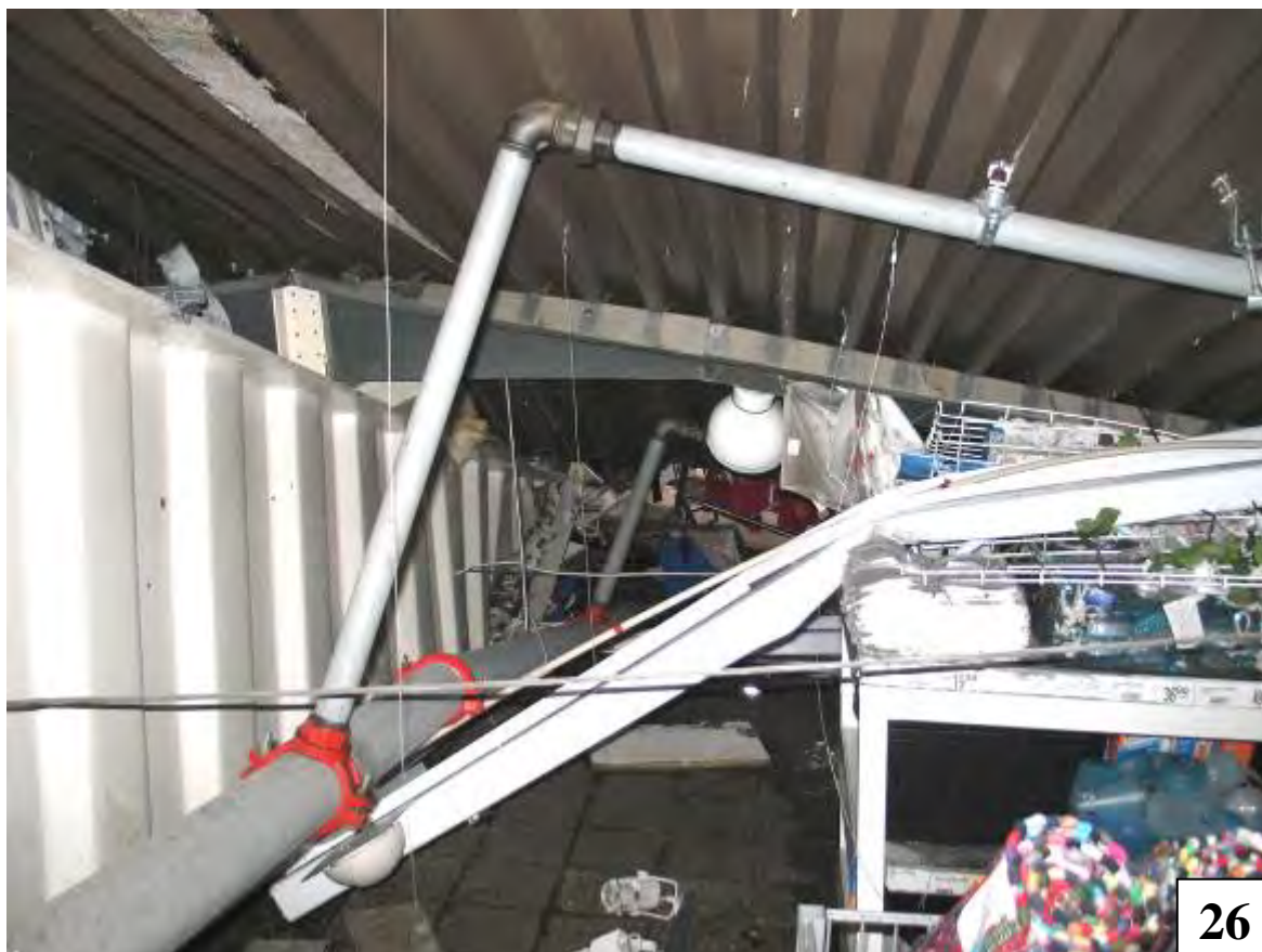
Takstolen som sitter på pelare 6C har kollapsat mot söder. I taket syns cellplastens isolering.
