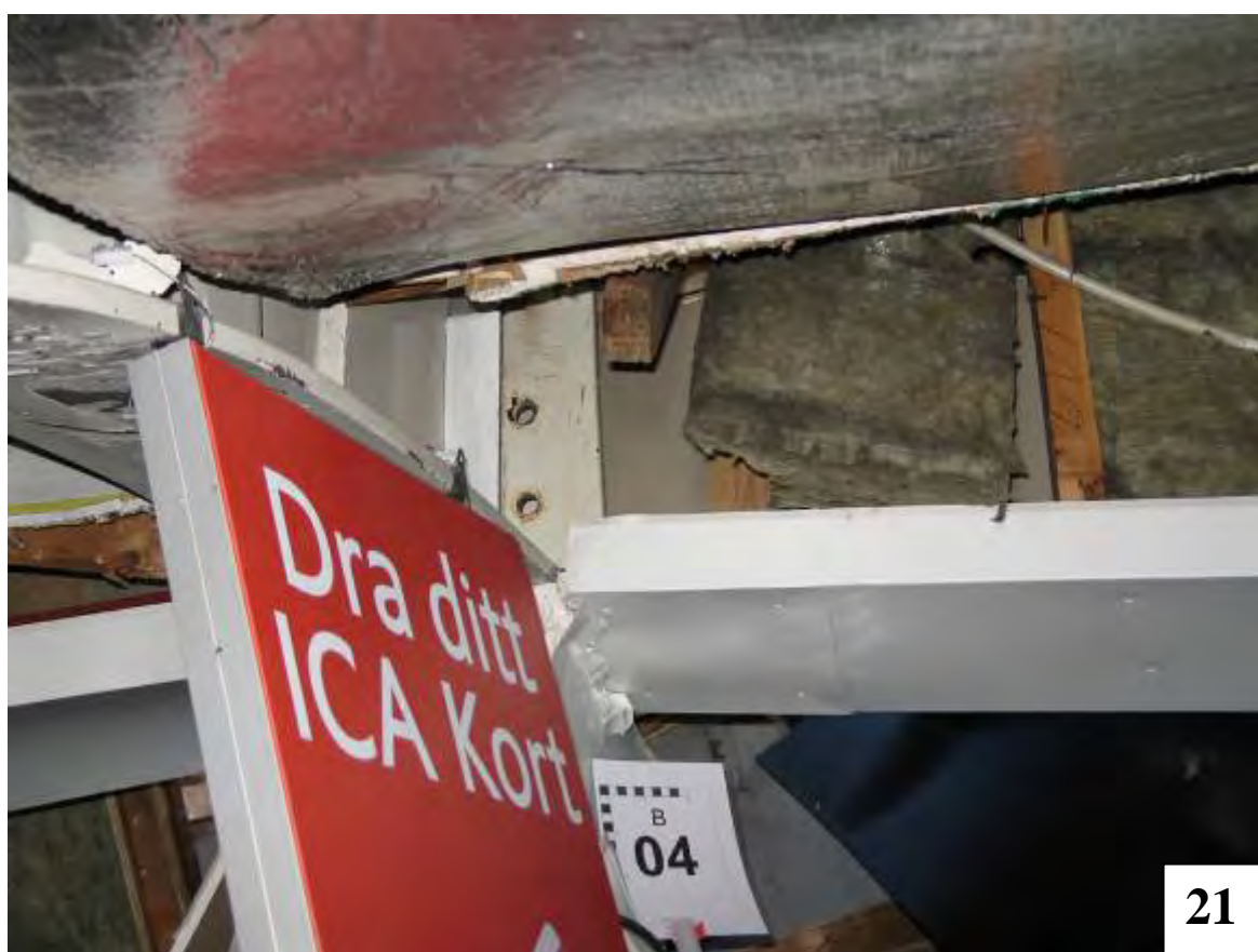
Pelare 5E, bultar är borta i takstolarna.
