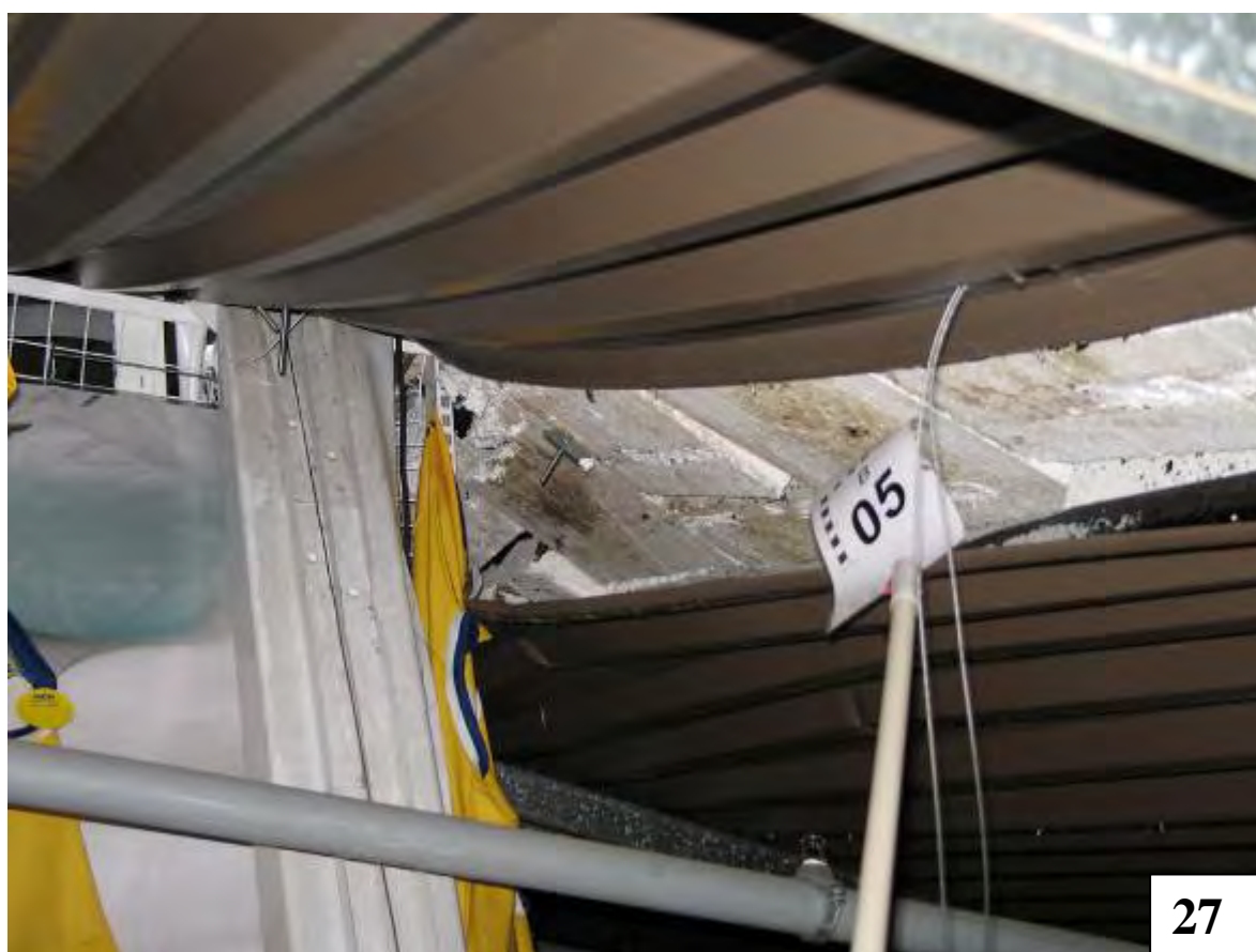
Bilden tagen från en annan vinkel. Cellplasten syns i området 6D till 6E, cellplasten är hel
