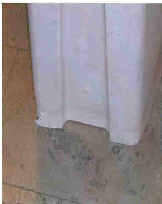
Sopkärlets skada i nedre vänstra hörnet.
