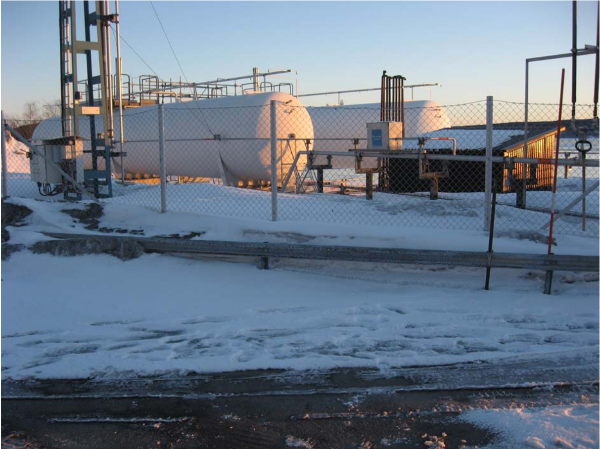
Här har vi en bild på cisternerna och pumphus.
