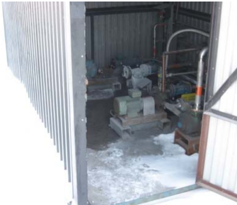
Här syns en fuktig fläck på golvet av den gasol som runnit ut. Samtidigt syns att ventilationen mellan plåtvägg och betongplatta är obefintlig. Det kan medföra att man får gasblandningar inom brännbarhetsområdet för gasol.
