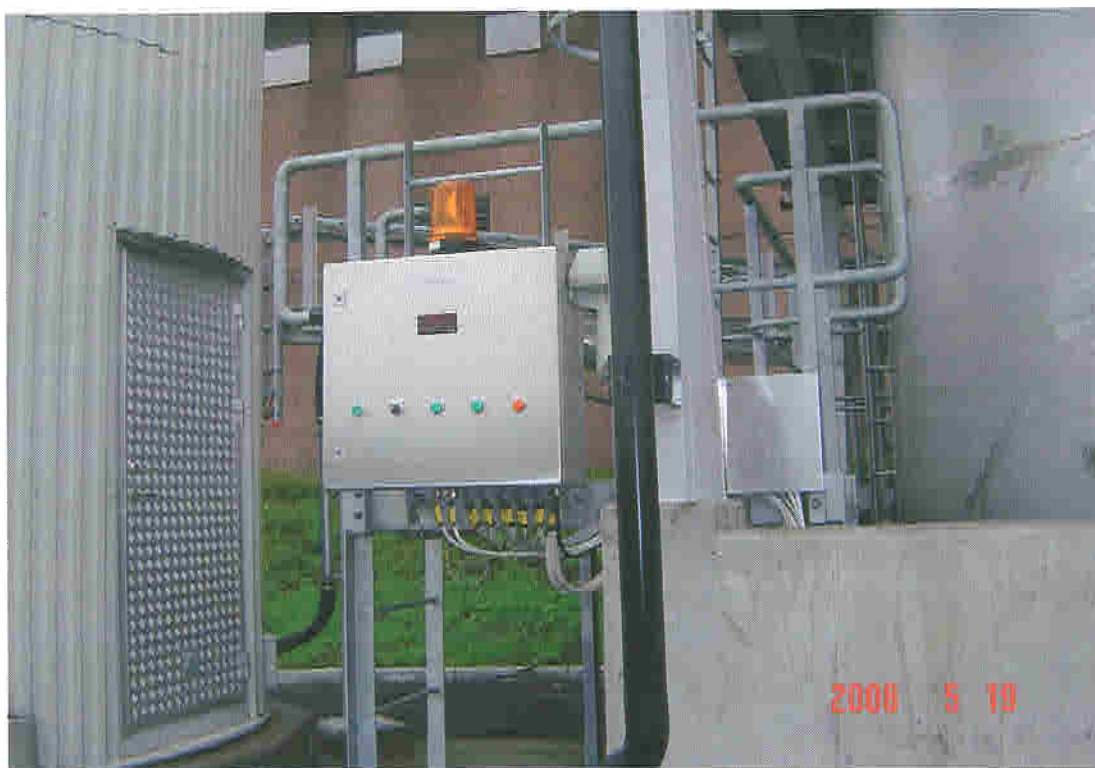
Manöverenheten till styrning av ventilerna.
