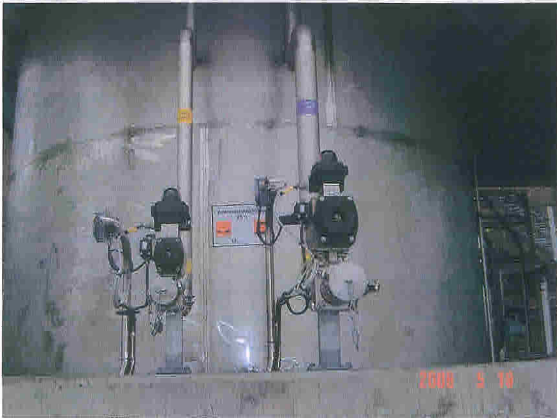
Bild på ventiler med anslutning, där monteringen framgår på invallningen.
