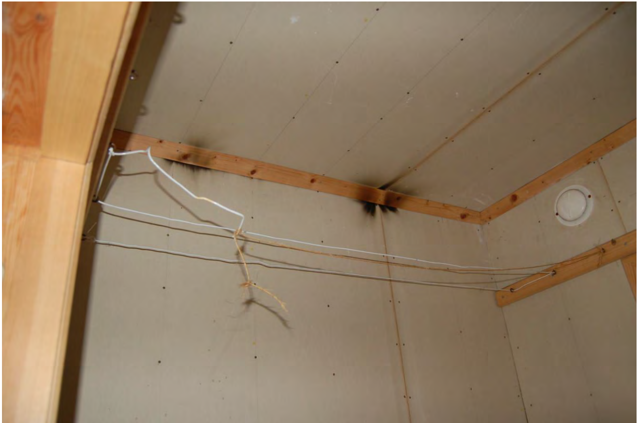
Otätet i väggkonstruktion som spridit rök
