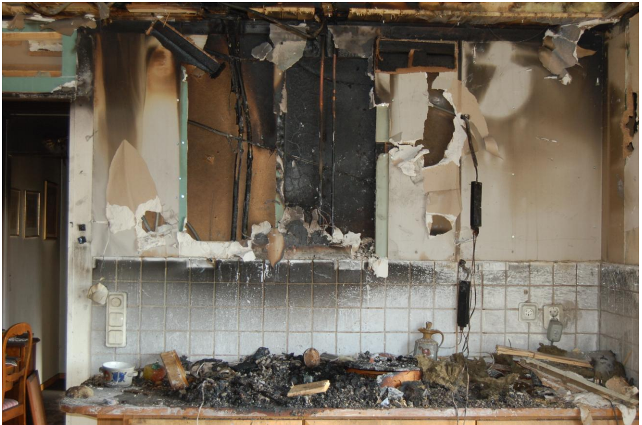
Kök med brandrester på underskåp. Överskåp borttaget. Tydlig brandbild innanför där överskåpet suttit. Elinstallation till spotlight påvisar endast sekundärskador.
