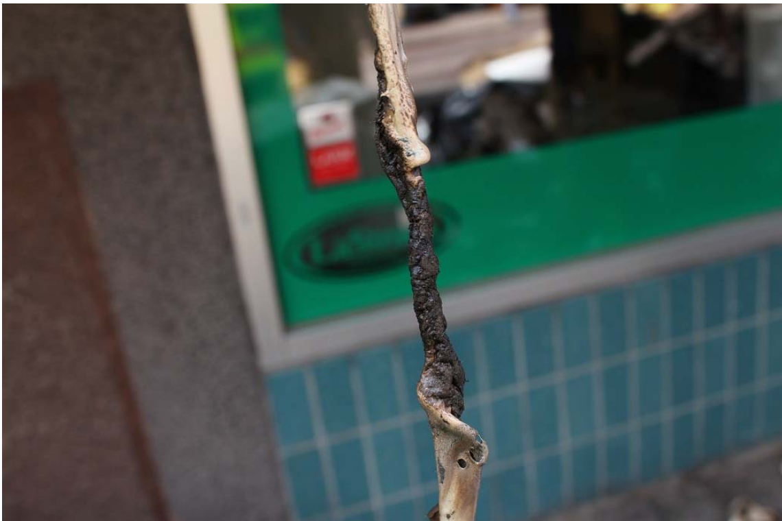
Bild 4. Kabeln från frysboxen har smält ihop, därav har säkringen troligtvis löst ut i centralen.
