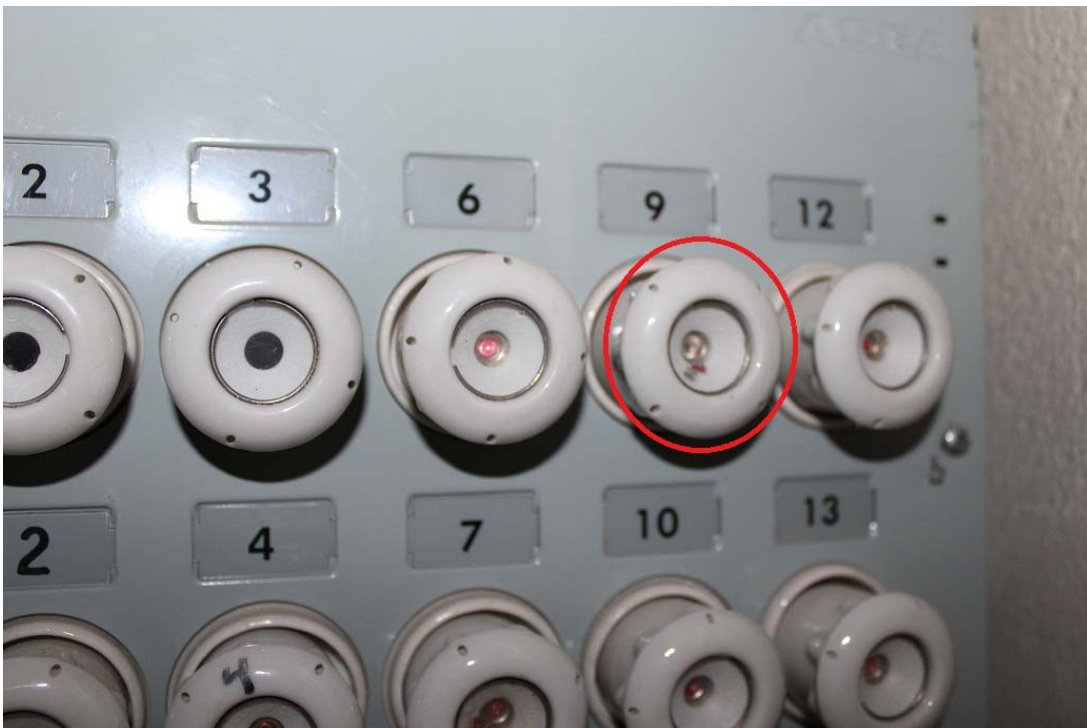
Bild 2. Säkringen till spisen och strömuttaget ovanför spisen har löst ut när kabeln till fryboxen smälte ihop pga värmen.
