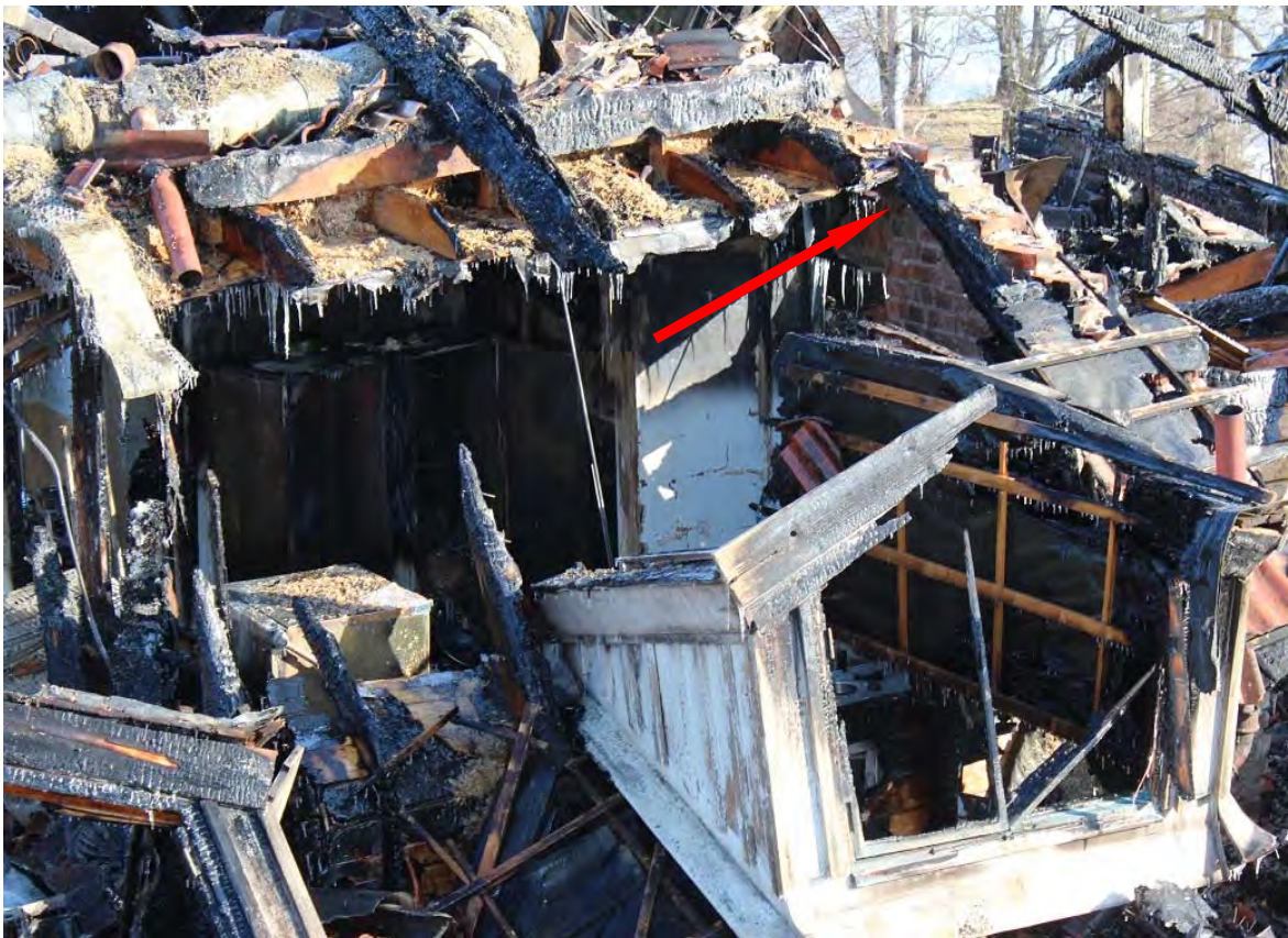
Bild från köket, pilen visar vart röken kom fram under taklisten.
