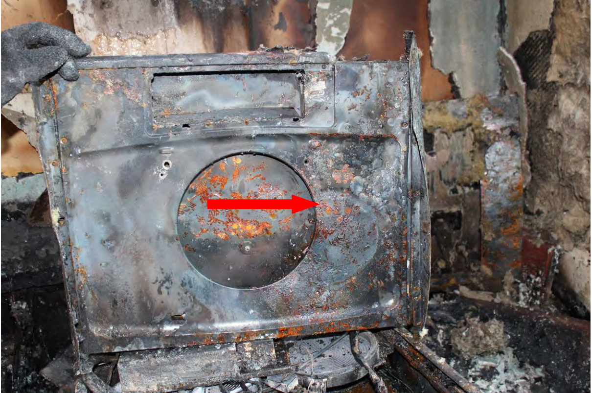
Bild 11. Spiskåpan är hårt bränd på höger sida.
