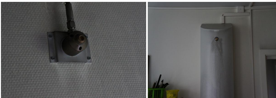
Bild [5,6] Sprinklermunstycken monterade på vägg i sovrummet och på basenhet.
