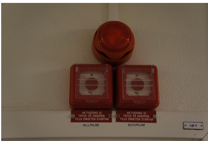
Bild [7] Manöverpanel och larmdon utanför lägenhetsdörr.
