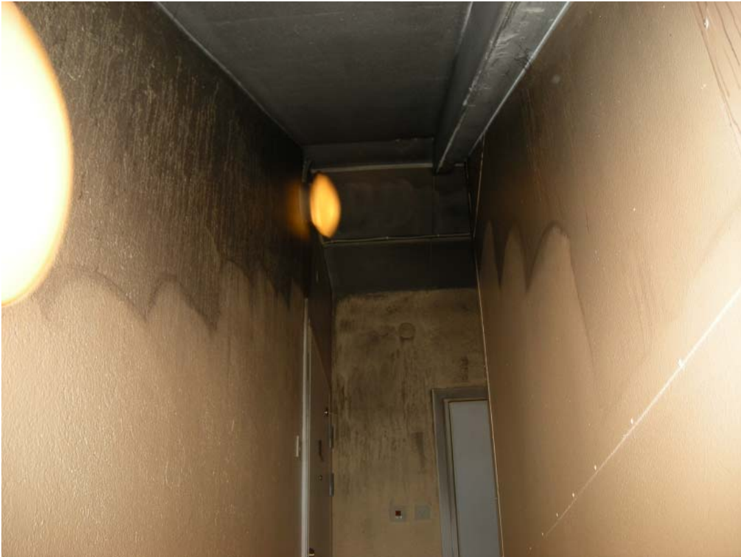
Bild 6, Trapphuset rök-och sotskadades och omfattande sanering kommer att krävas.
