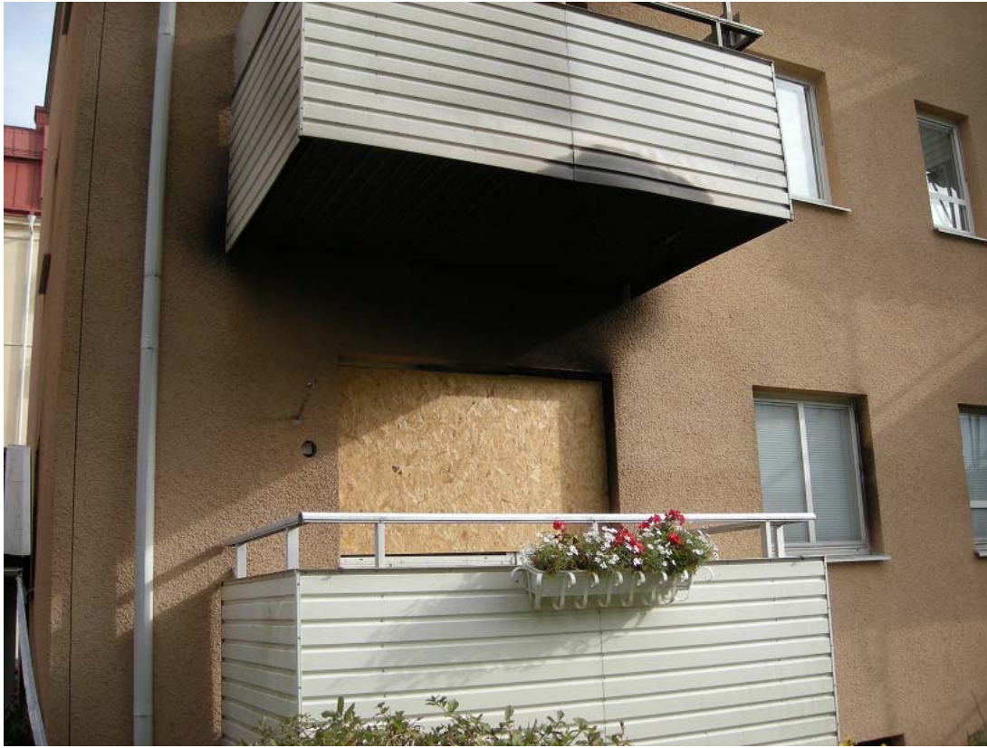
Bild 4 På bilden syns värmepåverkan på balkongen som är belägen ovanför brandlägenheten
