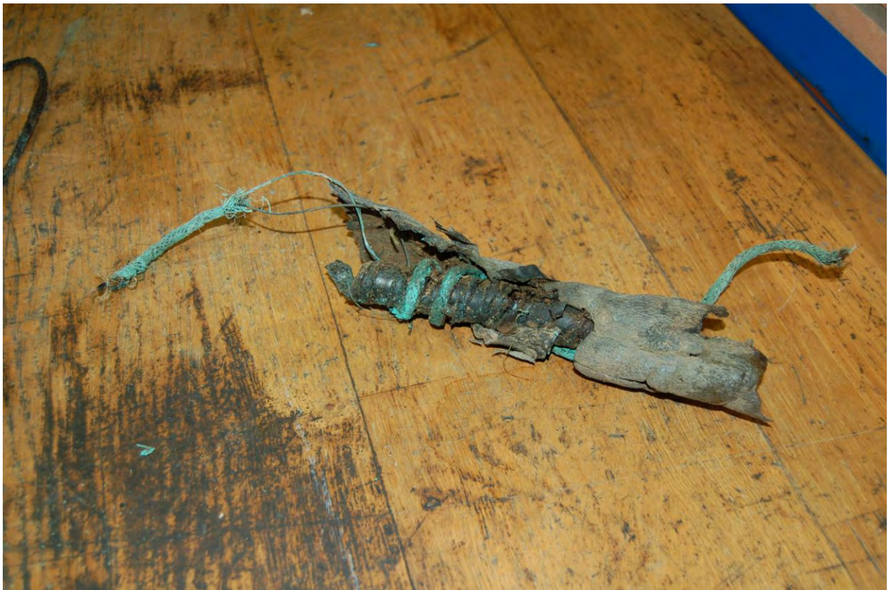
Nedre delen av vattenledningen med värmekabeln (utan yttre isolering) virad runt och därefter värmeisolering utanpå
