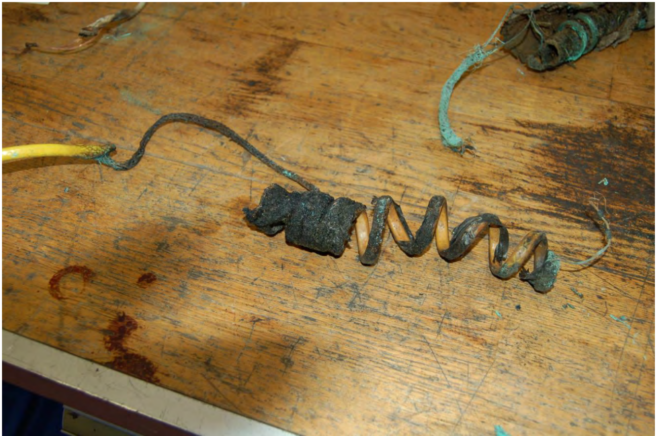
Värmekabeln (med yttre isolering) som den var virad runt övre delen av vattenledningen
