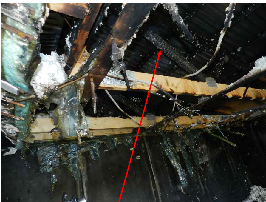
Bild 10. Kraftigt kolade takstolar i vardagsrummet.
