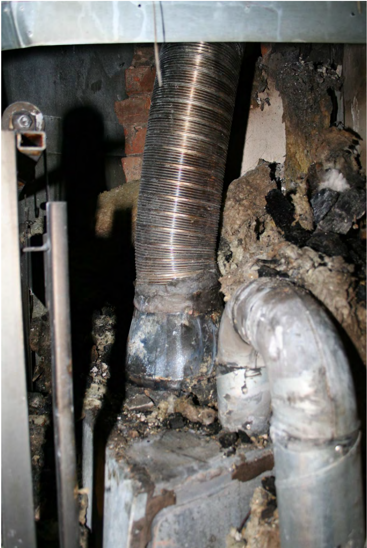
Foto 7. Del av det oisolerade rökröret.
