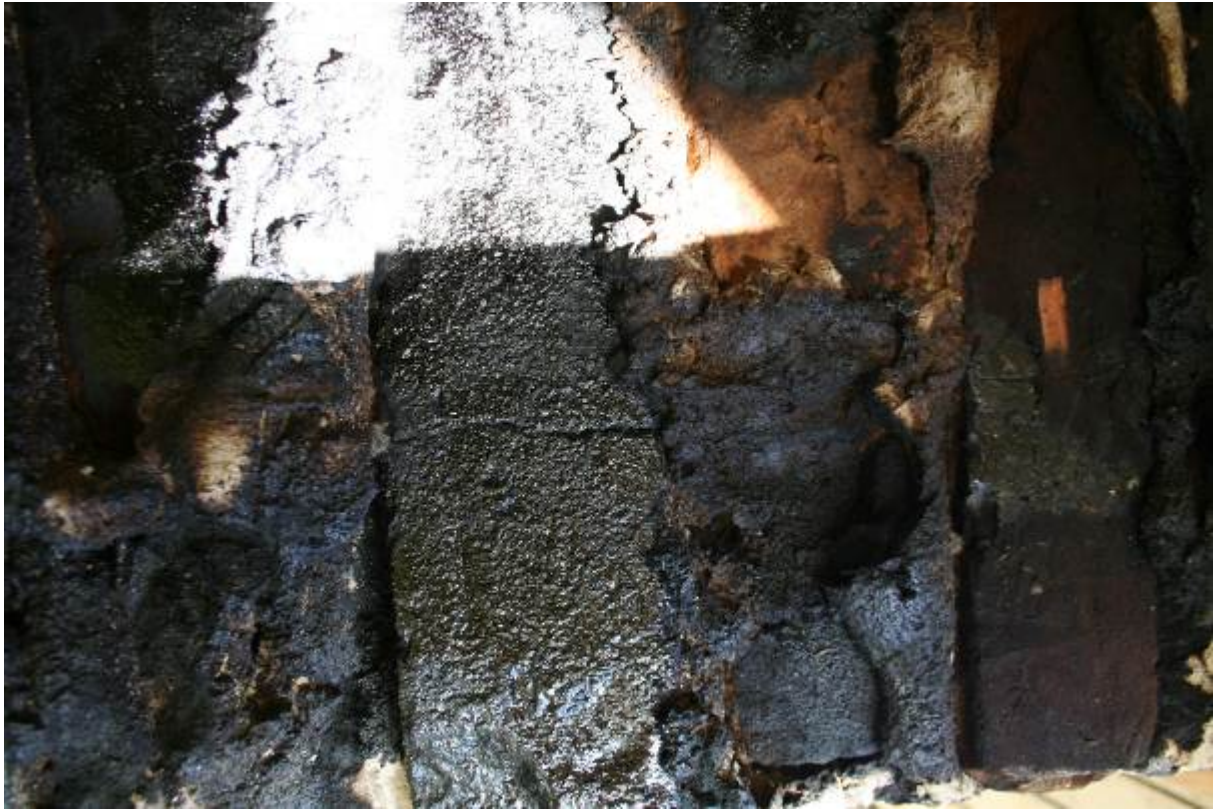
Bild 8 Tjära, sot och sprickor på utsidan av murstocken
