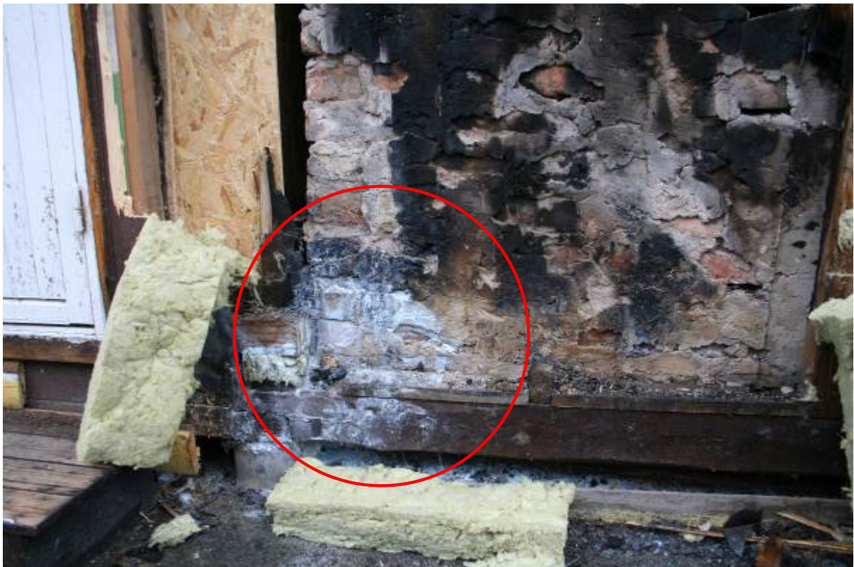
Bild 6 Nedre delen av murstocken där ägaren gjorde en släckinsats
