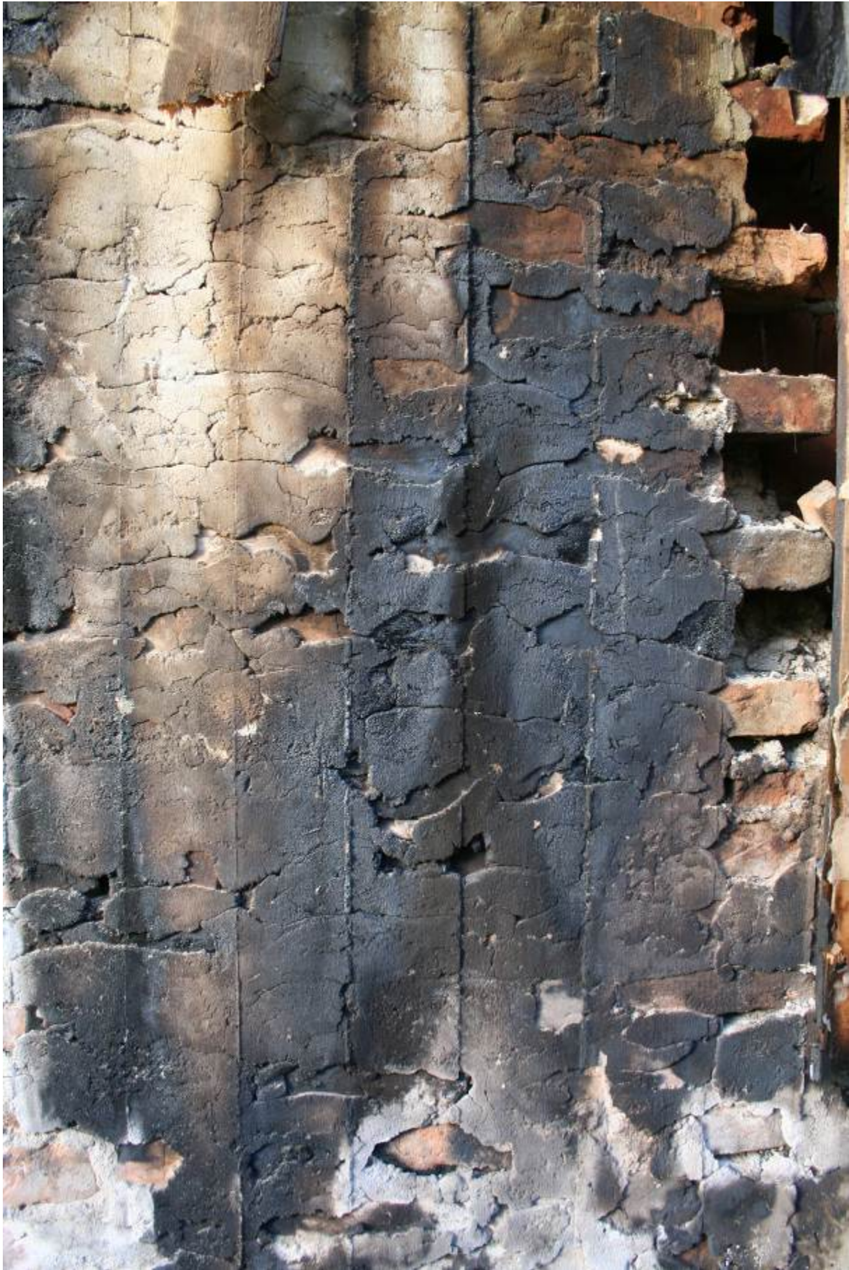
Bild 7 Närbild på murstocken, där luftspalt saknades och branden startade
