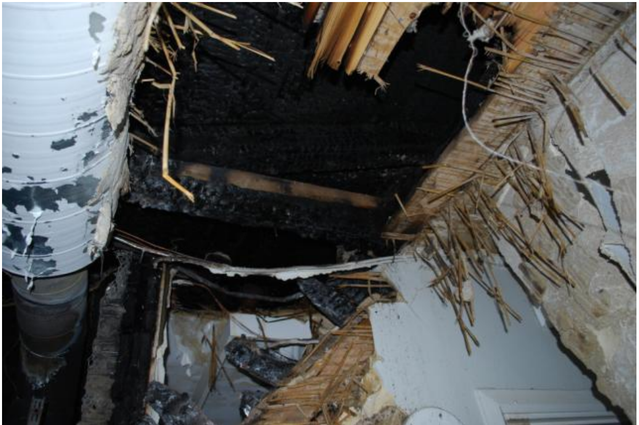
Vägg och tak utanför ventilationsrum.
