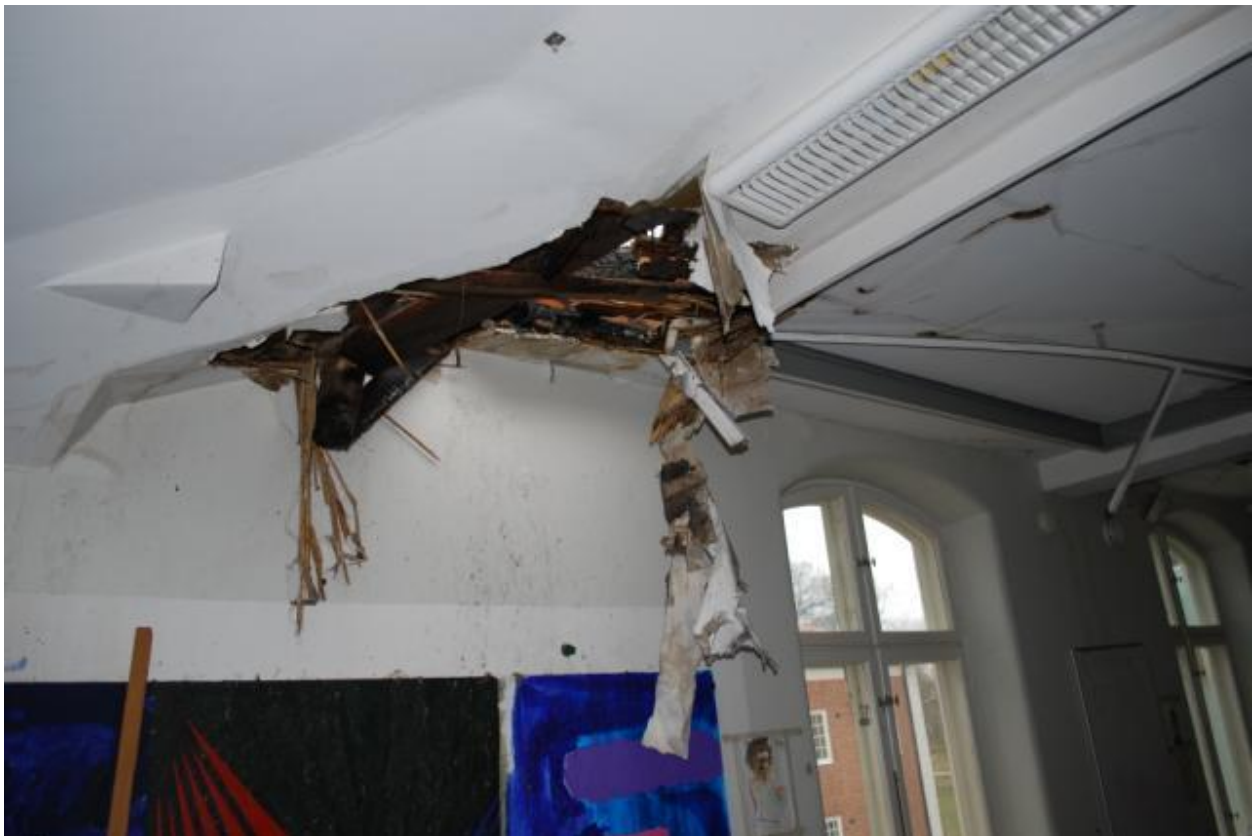
Skador på insidan.
