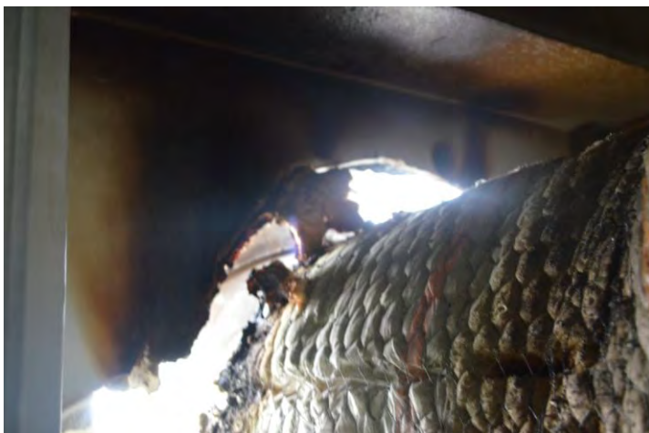
Överdel av rökkanalen ut i det fria
