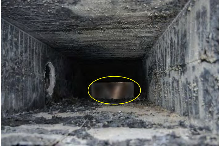
Endast en plåt sitter i den gamla genomföringen
