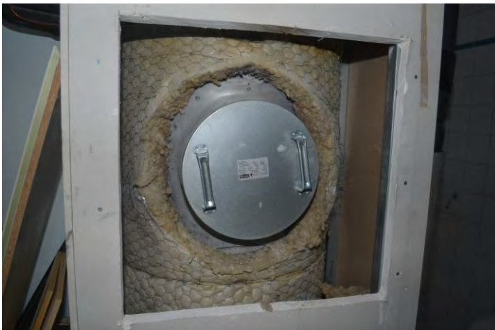
Renslucka som satt helt löst på plan tre. Gipsschakt med stålreglar.
