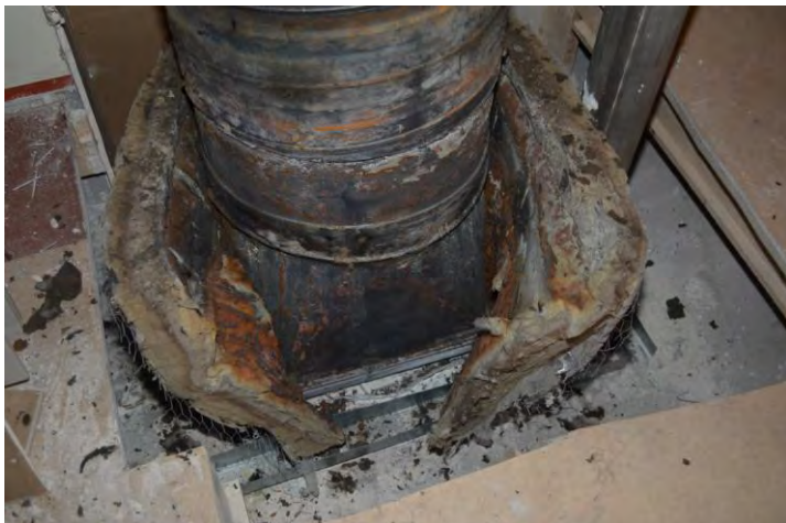
Genomföring av spirorör mellan plan ett och två. Brandtätning runt rör intakt. Kraftiga brandskador på spirorör. Tydliga brandskador även på isolering.
